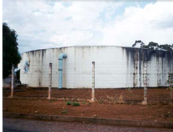
Figura 3.15 Reservatório da Saneago – Minaçu
