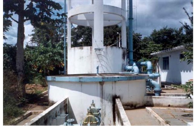
Figura 3.7 Estação de tratamento de água - Palmeirópolis
