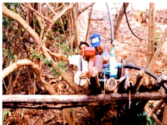
Figura 5.3 Rio Tocantins, margem direita, captação de água por bomba
