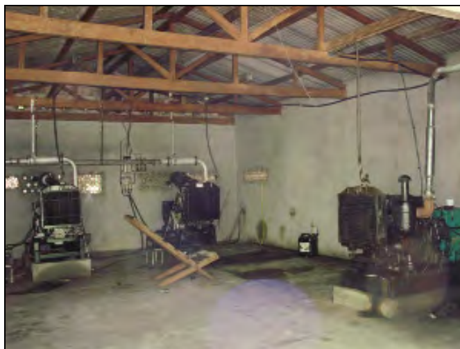
Foto 11 - Casa de geradores de energia.
