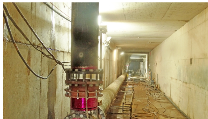
Sistemas Auxiliares Mecânicos - Galeria EL. 100,40
