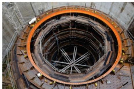
Unidade Geradora 2 (UG-2)
