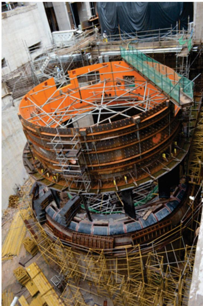
Unidade Geradora 1 (UG-1)
