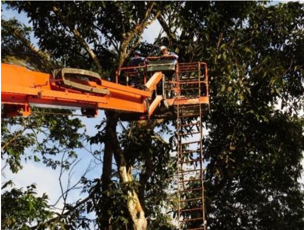
Figura 1-43: Substituição da passagem de fauna área instalada em acesso interno do empreendimento UHE São Manoel.
