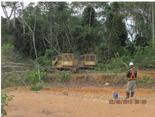
Figura 1-11: Acompanhamento das atividades de supressão vegetal no processo de bosqueamento com uso de trator esteira.
