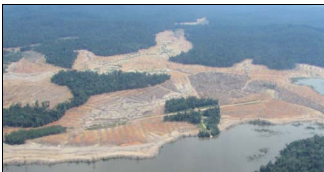
Figura 5: Lote 02 e áreas adicionais. ASVs 1123/2016, 1155/2016 e 1169/2016. À esquerda, fragmento de vegetação de futura ilha do reservatório.
