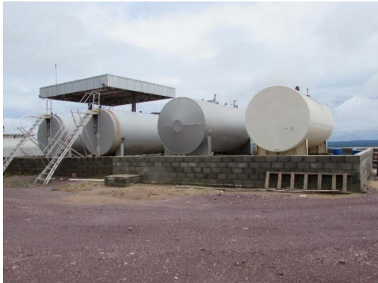
Figura - 36 Vista geral dos quatro tanques de diesel.
