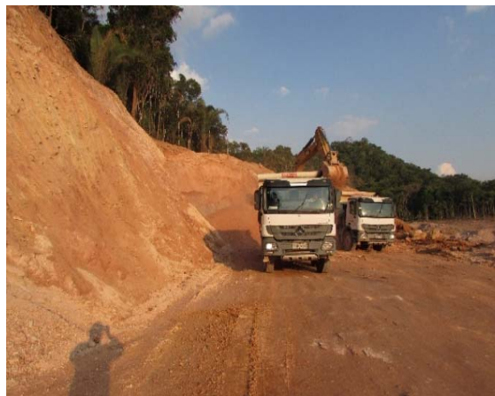
Figura - 49 - Vista da AE 08 em atividade.
