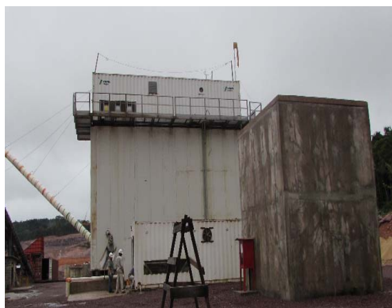
Figura - 92 - Estrutura montada central e caixa de água, utilizada como reservatório
