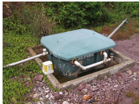
Figura - 39 Dispositivo de Caixa Separadora de água/óleo capacidade de 20m 3 h.
