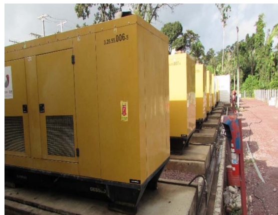
Figura - 62 - Piso impermeável e canaleta de direcionamento nas bases para acomodo dos geradores.
