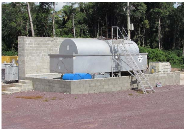
Figura - 61 - Tanque de combustível contemplado por duas contenções, sendo estrutura do próprio tanque e contenção de alvenaria.
