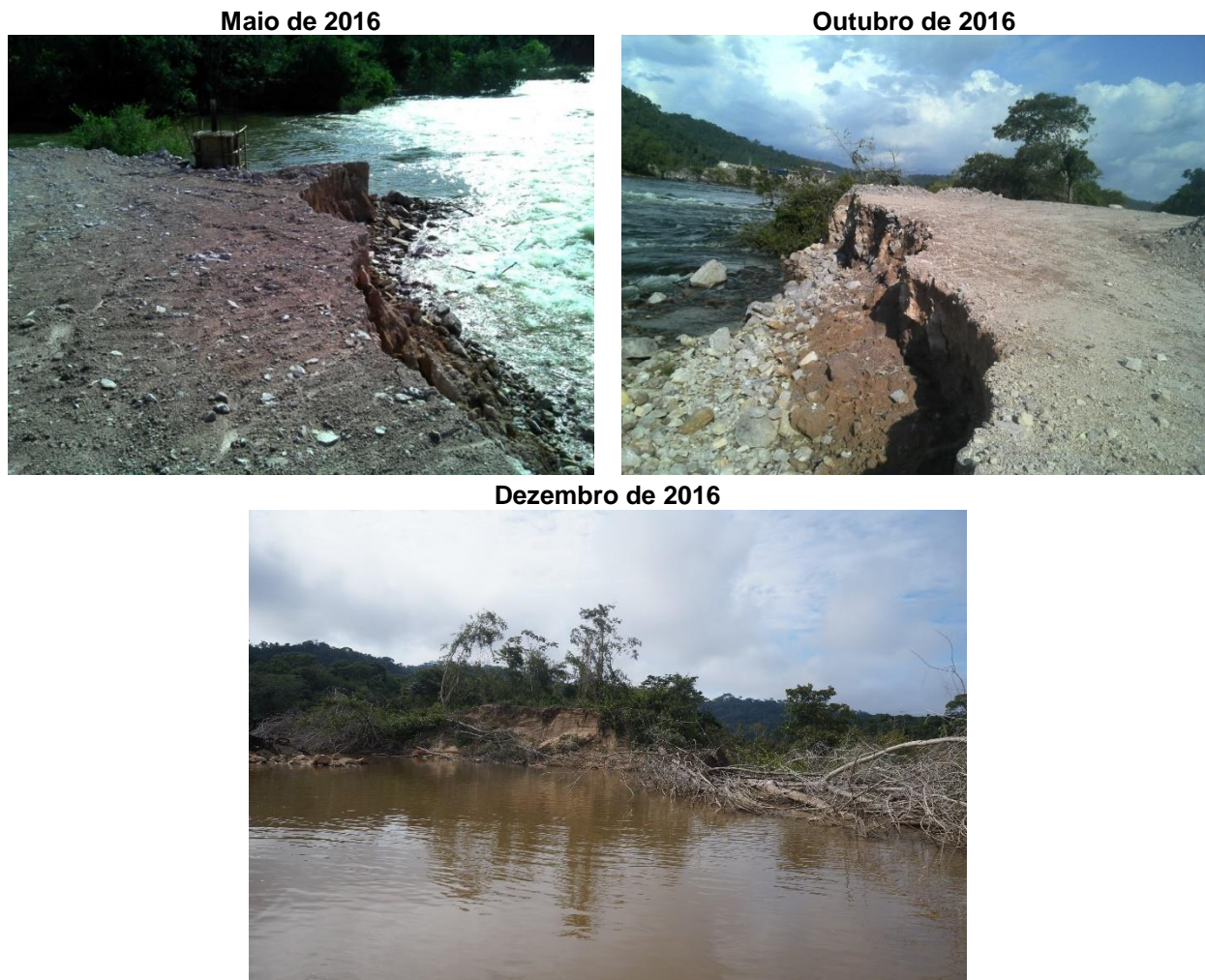
Figura 3.3: Margem aterrada erodida nas proximidades da foz do rio Apicás. Verificou-se que o enrocamento inserido nas margens foi carregado pelas altas vazões do rio Teles Pires.
