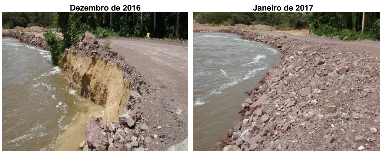
Figura 3.9: Erosão na margem direita do Canal de Fuga no mês de dezembro de 2016, quando foi catalogada, e em janeiro de 2017, após contenção através de implantação de enrocamento.
