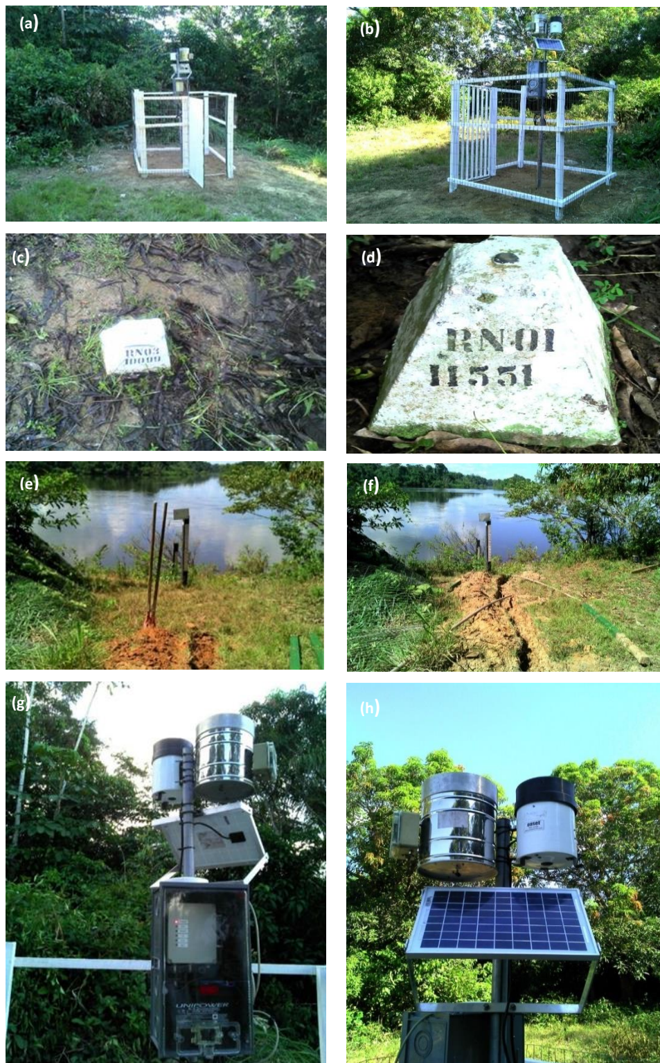
Figura 4.2: Instalação da estação UHE São Manoel Jusante 2, incluindo: (a) e (b) vista geral da estação com o cercado; (c) e (d) referências de nível (RN's); (e) e (f) lance de réguas; (g) pluviômetro com datalogger ; e (h) pluviômetro com placa solar.
