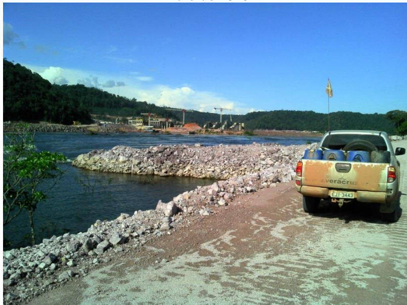
Figura 4.19: Margem esquerda do rio Teles Pires aterrada e enrocada. Verificou-se que o enrocamento inserido apresenta-se estável.
