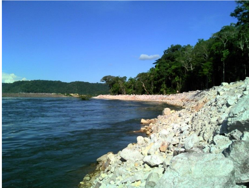
Figura 4.20: Margem esquerda do rio Teles Pires enrocada, entre as proximidades do ponto 2 e 4 do mapa da Figura 4.22. Verificou-se que o enrocamento apresenta-se estável.
