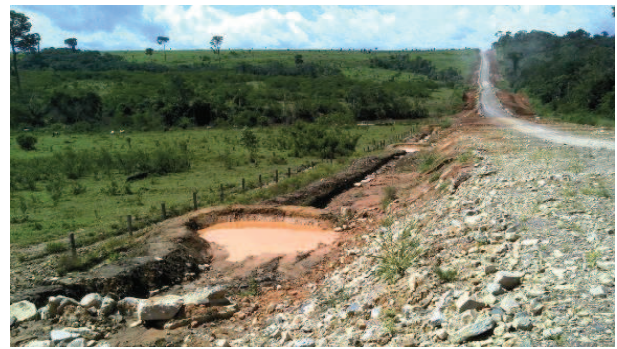
Figura 139: Bacia de decantação
