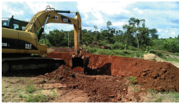
Figura 138: Bacia de decantação
