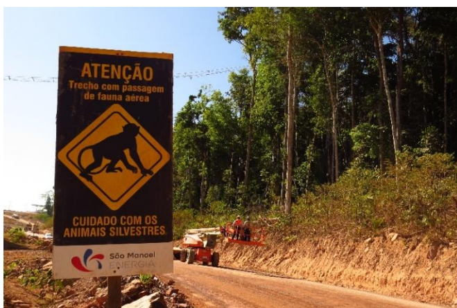
Figura 3.18.3-7: Sinalização para a passagem de fauna aérea em acesso interno do canteiro de obras.
