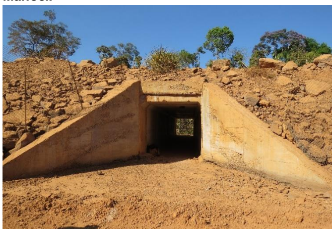
Figura 3.18.3-11: Passagem de fauna subterrânea (B) implantada no acesso principal do empreendimento UHE São Manoel.
