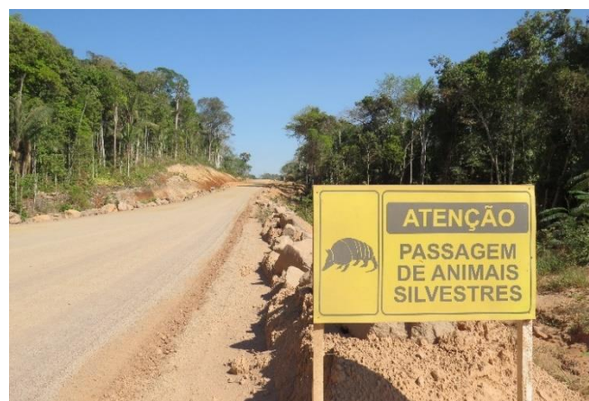
Figura 3.18.3-8: Placa alertando sobre a passagem de fauna na via de acesso a UHE São Manoel.
