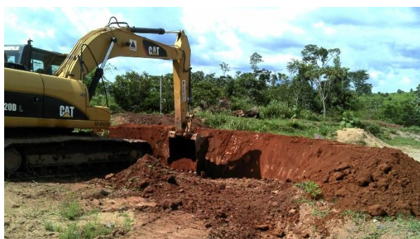
Figura 3.3.3.3-4: Bacia de decantação
