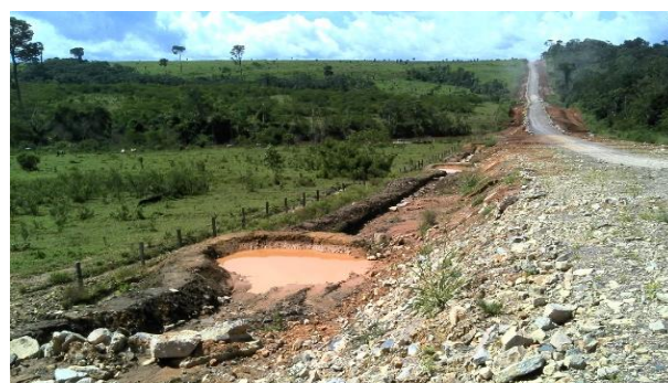
Figura 3.3.3.3-5: Bacia de decantação
