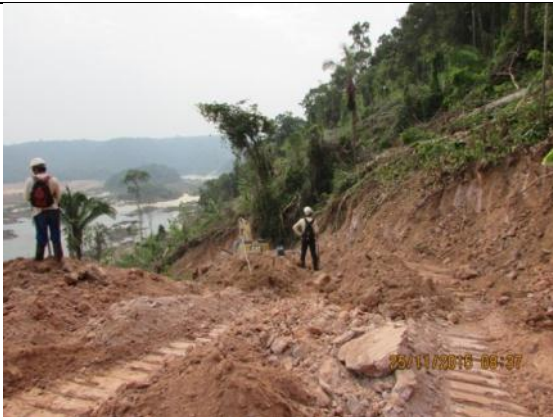
Figura 255: Acompanhamento das atividades de supressão vegetal mecanizada na margem esquerda do Rio Teles Pires durante o 16º mês do Programa de Resgate e Salvamento Científico da Fauna na área de instalação do canteiro de obras da UHE São Manoel.
