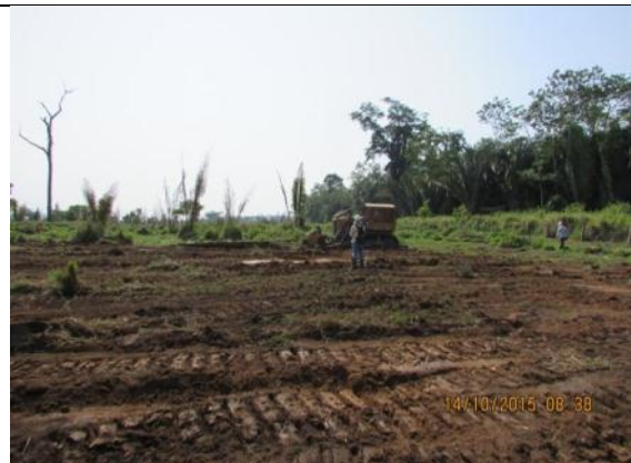
Figura 194: Acompanhamento das atividades de supressão vegetal mecanizada no Acesso Principal durante o 15º mês do Programa de Resgate e Salvamento Científico da Fauna na área de instalação do canteiro de obras da UHE São Manoel.
