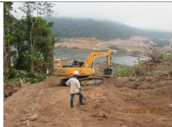
Figura 236: Acompanhamento de supressão mecanizada na margem esquerda do Rio durante o 16º mês do Programa de Resgate e Salvamento Científico da Fauna na área de instalação do canteiro de obras da UHE São Manoel.
