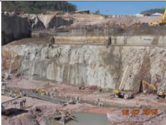
Figura 59: Vistoria geral pela obra durante o 12º mês do Programa de Resgate e Salvamento Científico da Fauna na área de instalação do canteiro de obras da UHE São Manoel.
