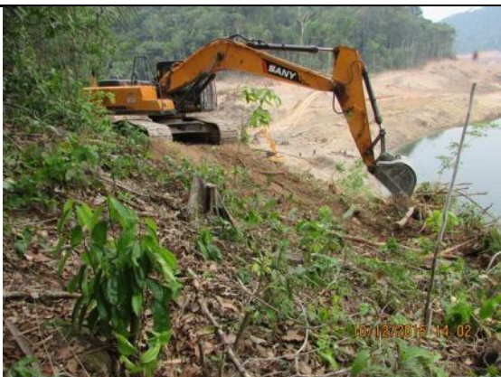
Figura 265: Acompanhamento das atividades de retirada de material vegetal suprimido na margem esquerda do Rio Teles Pires durante o 17º mês do Programa de Resgate e Salvamento Científico da Fauna na área de instalação do canteiro de obras da UHE São Manoel.
