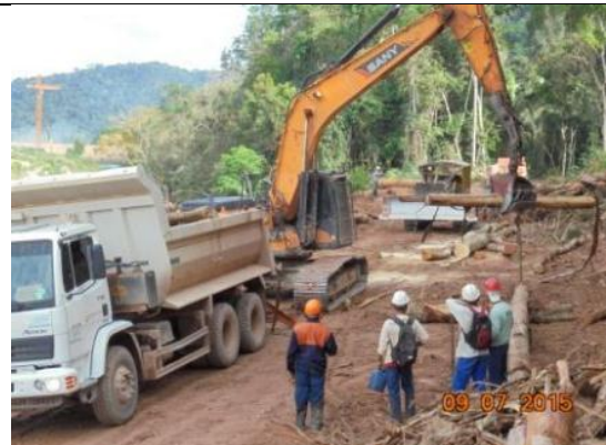
Figura 26: Acompanhamento das atividades relacionadas à retirada de madeira da área recém suprimida durante o 12º mês do Programa de Resgate e Salvamento Científico da Fauna na área de instalação do canteiro de obras da UHE São Manoel.
