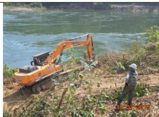
Figura 40: Acompanhamento da separação de toras e refugo vegetal na ilha durante o 12º mês do Programa de Resgate e Salvamento Científico da Fauna na área de instalação do canteiro de obras da UHE São Manoel.
