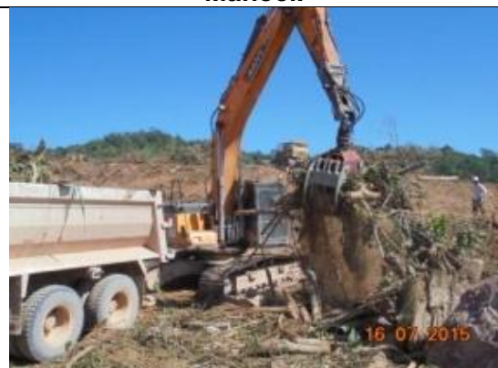
Figura 58: Acompanhamento das atividades de retirada de refugo vegetal de área suprimida durante o 12º mês do Programa de Resgate e Salvamento Científico da Fauna na área de instalação do canteiro de obras da UHE São Manoel.
