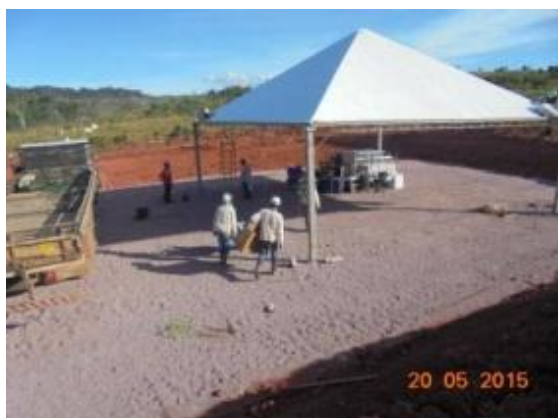
Figura 12: Tenda da BRP sendo montada pela equipe de Cuiabá e material de trabalho sendo guardado durante Programa de Resgate e Salvamento Científico da Fauna na área de supressão vegetal para instalação do canteiro de obras da UHE São Manoel.
