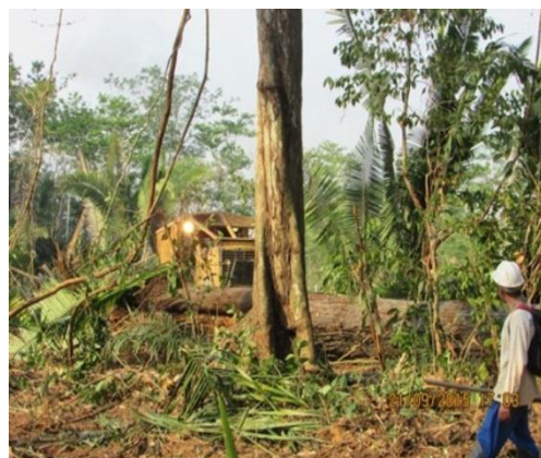
Figura 15: Acompanhamento das atividades de supressão mecanizada no Acesso A durante o 14º mês do Programa de Resgate e Salvamento Científico da Fauna na área de instalação do canteiro de obras da UHE São Manoel.
