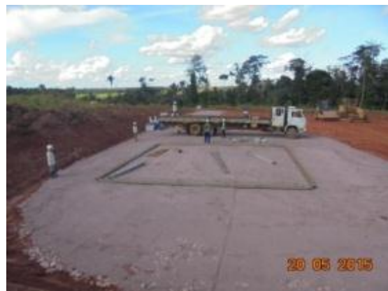
Figura 11: Planejamento do local para a montagem da tenda da BRP durante Programa de Resgate e Salvamento Científico da Fauna na área de supressão vegetal para instalação do canteiro de obras da UHE São Manoel.
