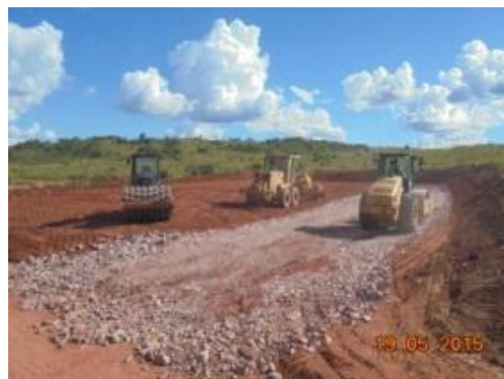
Figura 9: Nivelamento e compactação da camada de rachão para a relocação da BRP. Programa de Resgate e Salvamento Científico da Fauna na área de supressão vegetal para instalação do canteiro de obras da UHE São Manoel.
