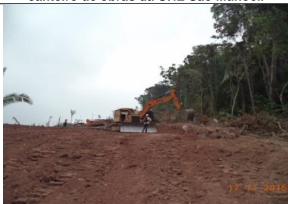
Figura 193: Acompanhamento das atividades de supressão na margem esquerda do rio durante o 16º mês do Programa de Resgate de Germoplasma Vegetal na área de supressão vegetal para instalação do canteiro de obras da UHE São Manoel.
