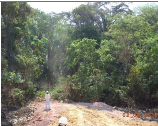
Figura 29: Equipe acompanhando as atividades na frente de supressão durante o 14º mês do Programa de Resgate de Germoplasma Vegetal na área de supressão vegetal para instalação do canteiro de obras da UHE São Manoel.
