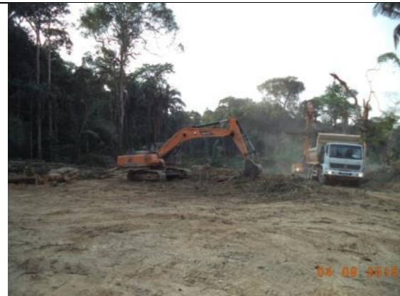
Figura 34: Acompanhamento das atividades na área durante o 14º mês do Programa de Resgate de Germoplasma Vegetal na área de supressão vegetal para instalação do canteiro de obras da UHE São Manoel.
