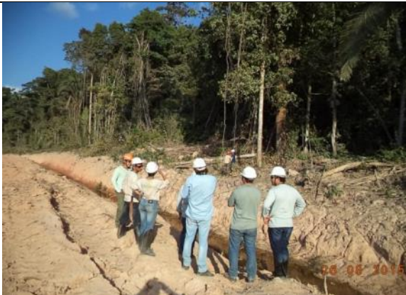
Figura 25: Vistoria das matrizes arbóreas pelos analistas ambientais do IBAMA durante o 13º mês do Programa de Resgate de Germoplasma Vegetal na área de supressão vegetal para instalação do canteiro de obras da UHE São Manoel.
