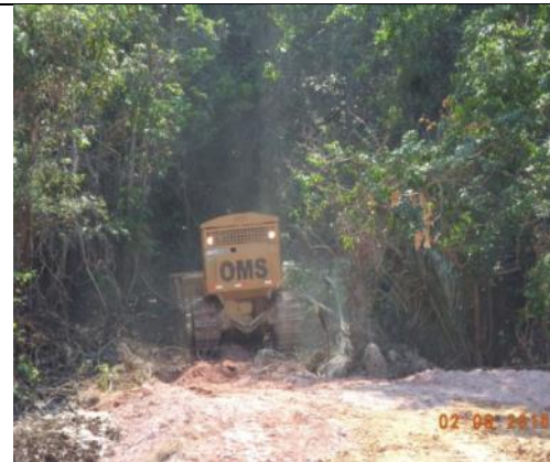
Figura 28: Acompanhamento das atividades de supressão vegetal durante o 14º mês do Programa de Resgate de Germoplasma Vegetal na área de supressão vegetal para instalação do canteiro de obras da UHE São Manoel.
