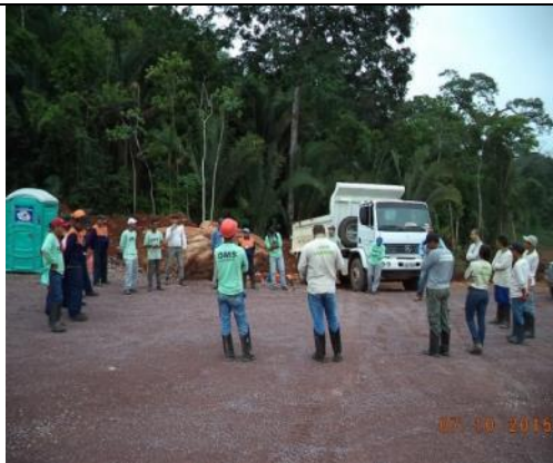
Figura 103: DDS entre os colaboradores da Biocev e OMS durante o 15º mês do Programa de Resgate de Germoplasma Vegetal na área de supressão vegetal para instalação do canteiro de obras da UHE São Manoel.
