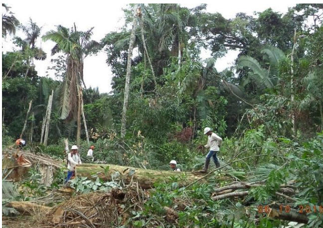
Figura 14: Resgate de germoplasma em área suprimida durante o 15º mês do Programa de Resgate de Germoplasma Vegetal na área de supressão vegetal para instalação do canteiro de obras da UHE São Manoel.
