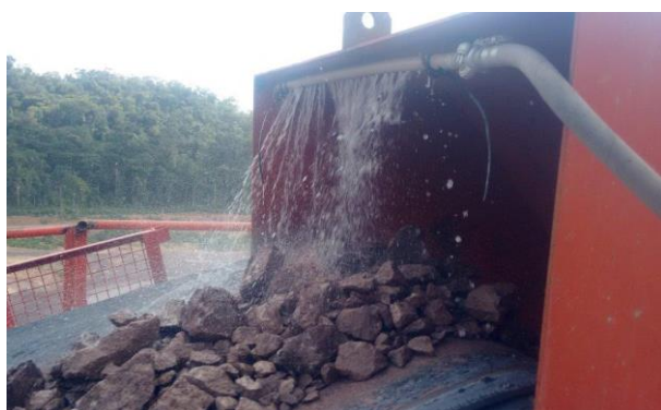
Figura 3.3-9: Central de britagem operante. Detalhe do aspersor de água junto ao britador.
