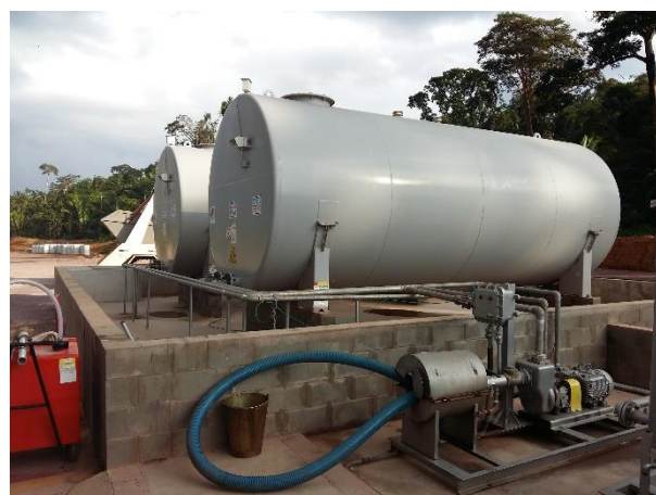
Figura 3.3-12: Tanques estacionários no ponto de abastecimento de combustível, em funcionamento.
