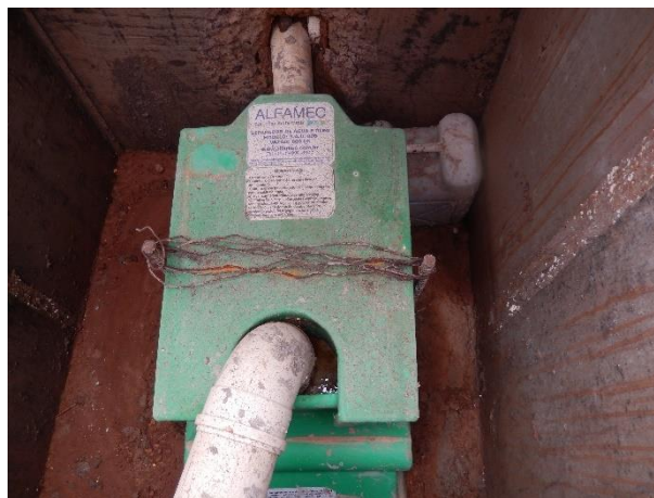
Figura 3.3.3-10: Caixa separadora de água e óleo (SAO) da landfarming .
