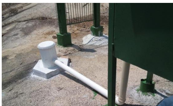
Figura 3.4-1: Visão externa do abrigo do sensor (sismógrafo) da estação.
