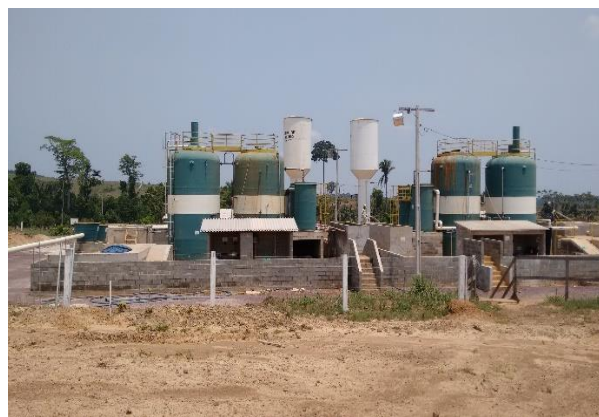
Figura 3.3-16: Estação de tratamento de efluentes.
