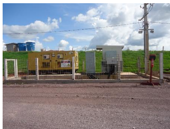
Figura 3.3.4-2: Bloqueio da unidade de apoio elétrico para segurança dos profissionais.
