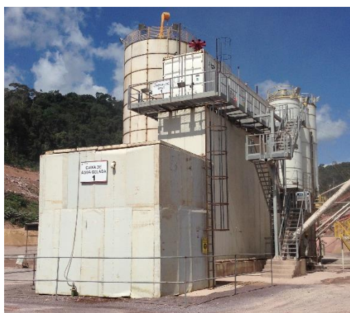
Figura 3.3-11: Central de gelo instalada.
