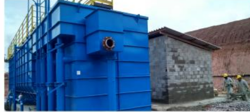
ETA - Execução da Estação de Tratamento D'água, onde será fornecido 100m 3 /hora de água limpa e tratada, atendendo toda a necessidade da obra.
