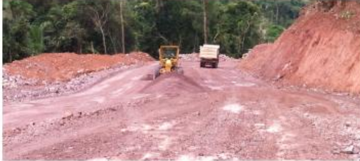
Acesso de Serviço - Execução do Serviço de Acesso, melhorando a logística entre os canteiros industriais e a usina de São Manoel.
