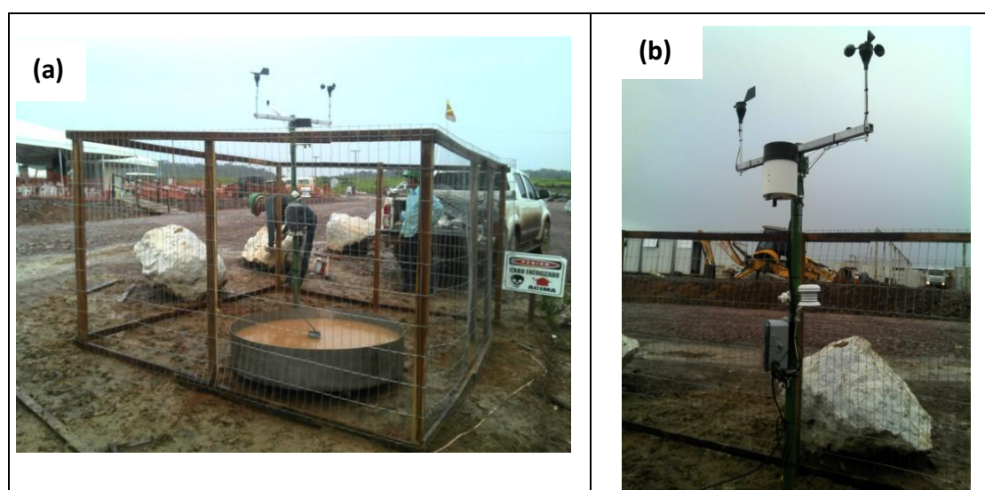
Figura 9. (a) Visão externa da estação meteorológica UHE São Manoel; (b) Sensores da estação meteorológica.
