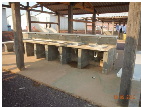
Figura 51: Vista aproximada dos tanques de limpeza de roupas.
