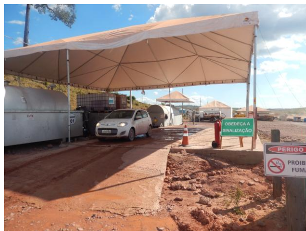
Figura 75: Vista lateral do ponto de abastecimento provisório de combustíveis.
