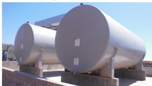
Figura 77: Vista dos tanques de abastecimento de 30.000L.
