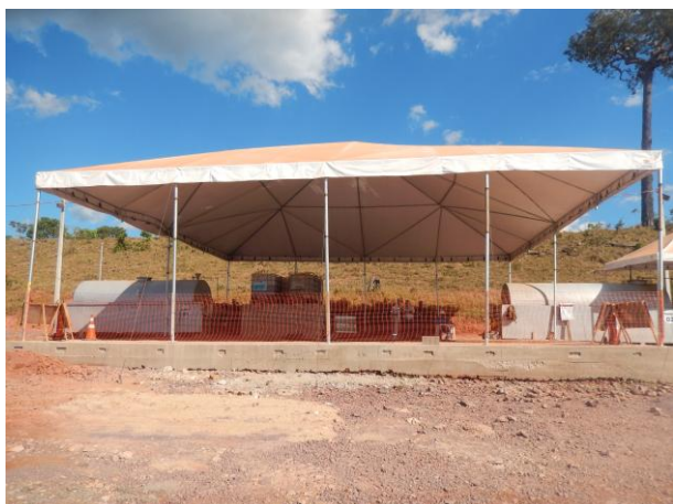
Figura 74: Vista do ponto de abastecimento provisório de combustíveis.
