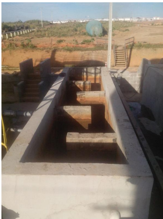
Figura 127: Vista geral do tanque de homogeneização dos efluentes tratados após a mistura.
