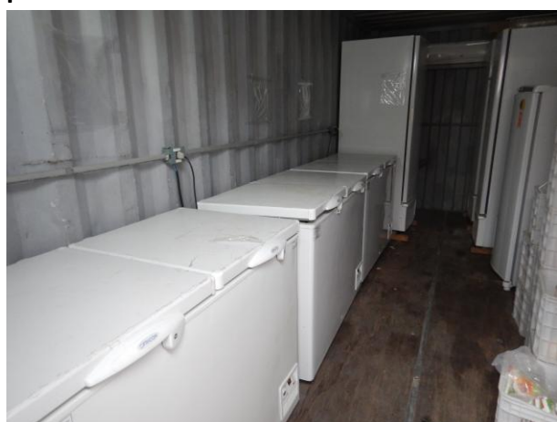
Figura 31: Vista geral do Freezers de armazenamento de alimentos perecíveis
