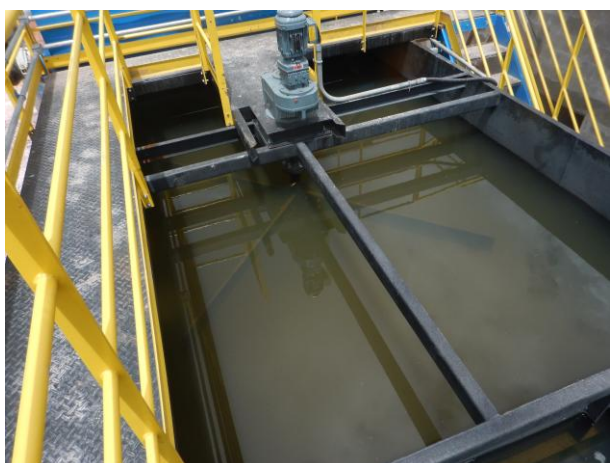
Figura 98: Vista do misturador da ETA.
