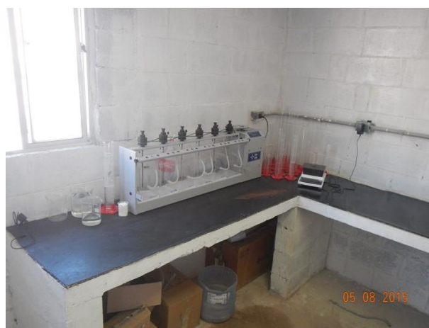
Figura 101: Vista do Jar Test instalado na ETA.
