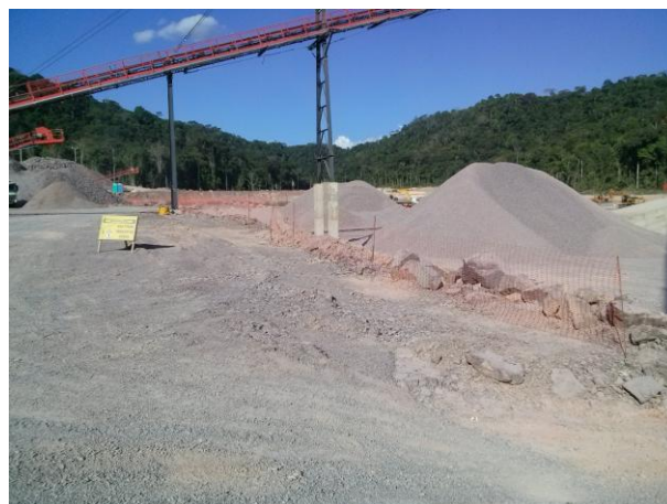
Figura 230: Proteção coletiva na central de concreto.
