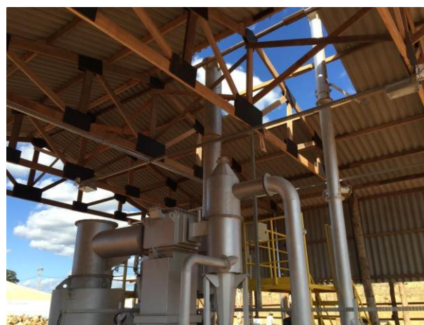
Figura 116: Incinerador em fase final de montagem no canteiro de obras da UHE São Manoel.
