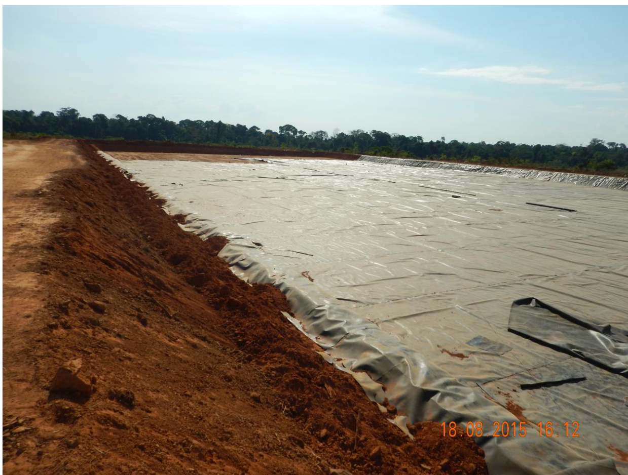
Figura 106: Vista geral da lagoa aeróbia em fase final de construção em 18 de agosto de 2015.
