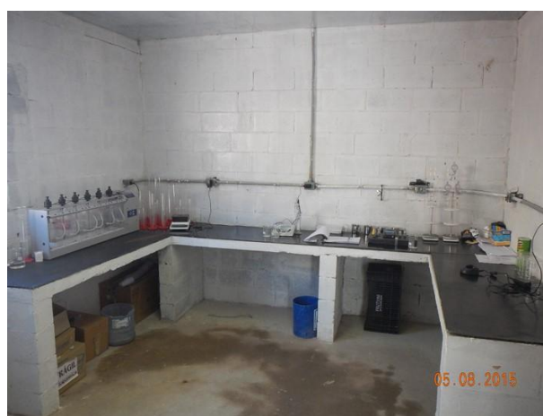
Figura 103: Vista geral do laboratório de monitoramento da qualidade da água da ETA.
