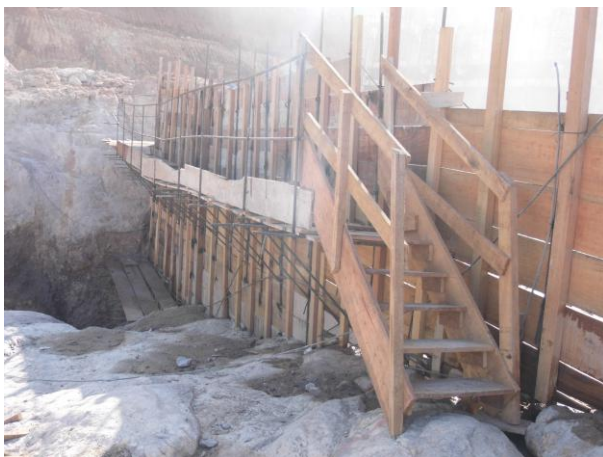
Figura 227: Guarda corpo na área de montagem.
