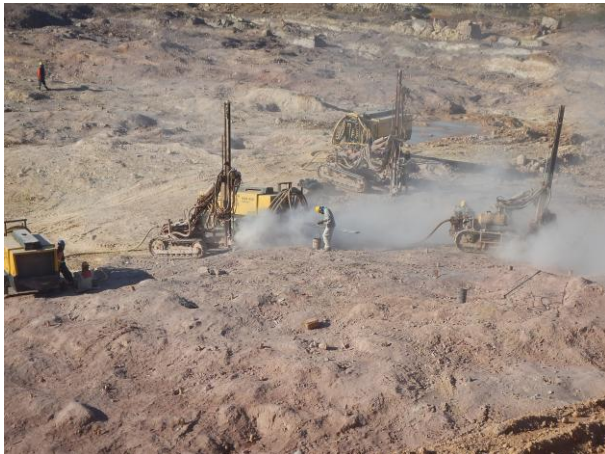
Figura 222: Vista geral da perfuração para aplicação dos explosivos, mediante plano de fogo.
