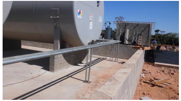
Figura 81: Vista da tubulação de combustível dentro da bacia de contenção.
