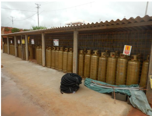
Figura 21: Vista geral da bateria de botijões de gás Propano - P45.
