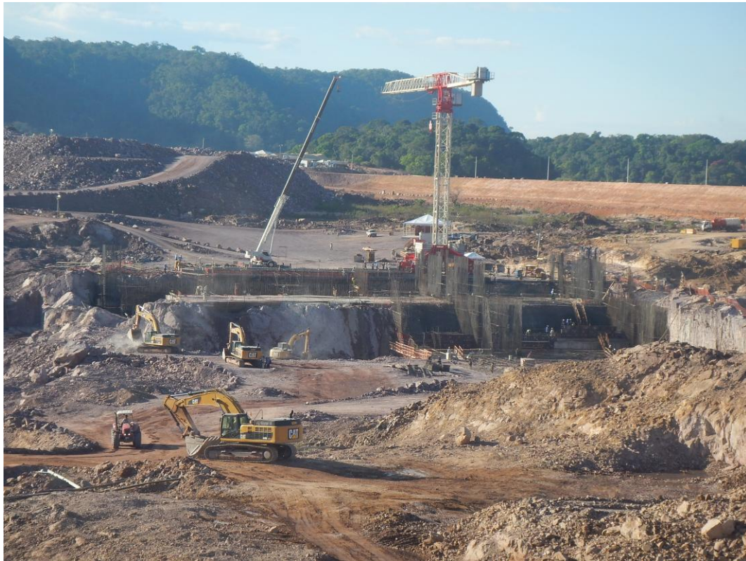
Figura 226: Vista geral da área de escavação e construção das estruturas da barragem.
