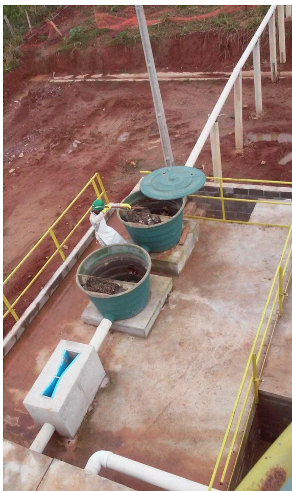
Figura 121: Vista superior do gradeamento dos efluentes domésticos no canteiro de obras da UHE São Manoel.
