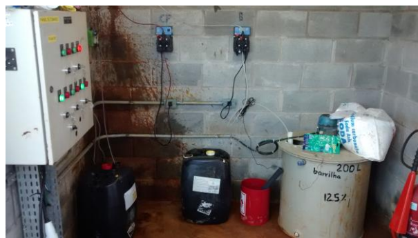
Figura 125: Vista do painel de controle da ETE da UHE São Manoel.
