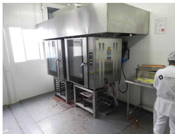
Figura 28: Vista geral dos fornos.
