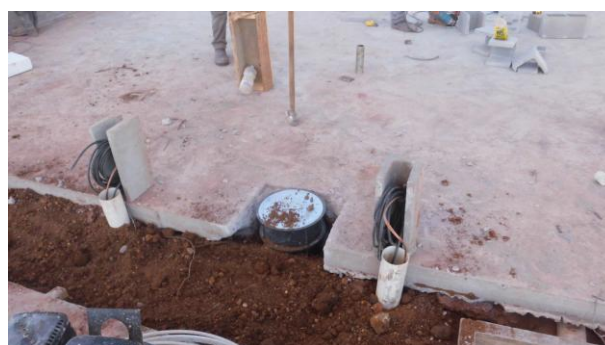
Figura 79: Vista do sistema de proteção contra descargas atmosféricas.
