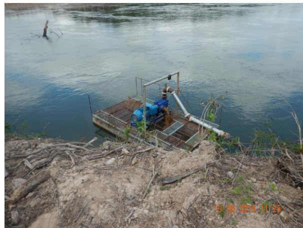
Figura 93: Vista do conjunto moto bomba que abastece os reservatórios de água bruta da UHE São Manoel.
