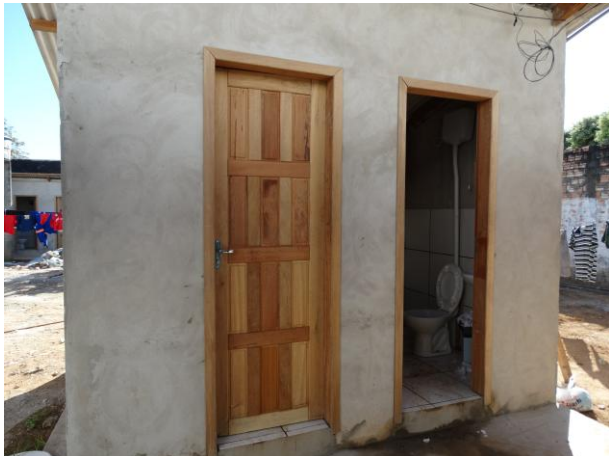
Figura 428: Vista do banheiro em frente ao banco Caixa Econômica Federal do município de Paranaíta – MT disponibilizado aos trabalhadores com manutenção e abastecimento contínuo.
