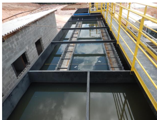
Figura 99: Vista do floculador da ETA.
