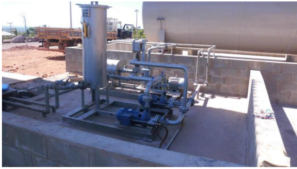
Figura 80: Vista do conjunto moto bomba e filtros.
