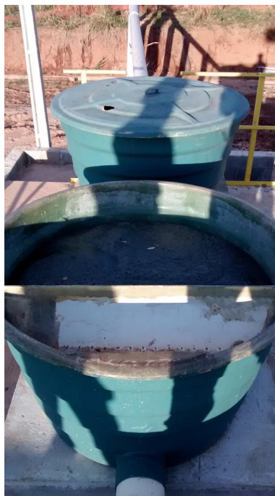
Figura 122: Vista do gradeamento dos efluentes domésticos no canteiro de obras da UHE São Manoel.
