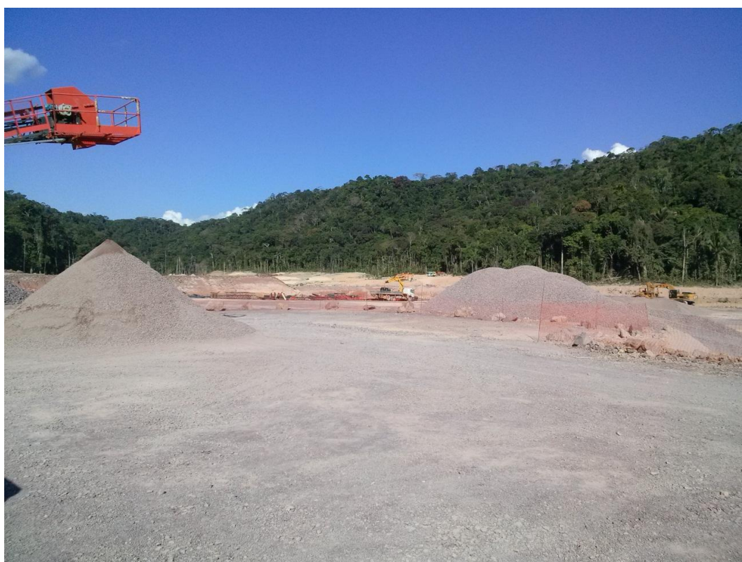
Figura 231: Proteção coletiva na central de concreto.
