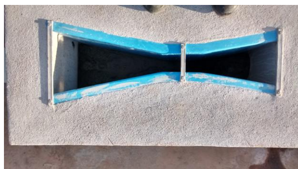
Figura 123: Vista da calha Parshall instalada para medição da vazão na estação de tratamento de efluentes da UHE São Manoel.
