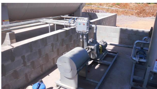
Figura 78: Vista das bombas de abastecimento.
