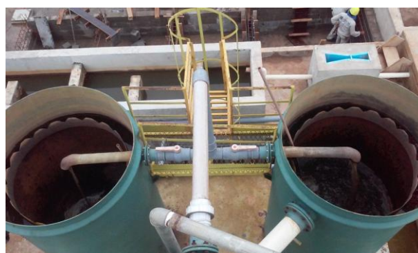
Figura 126: Vista geral dos dosadores no final do processo de tratamento dos efluentes.
