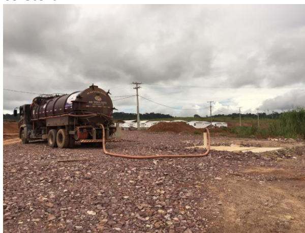
Figura 111: Vista geral da coleta de efluentes nas caixas coletoras (anterior à operação da ETE).
