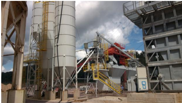
Figura 59: Vista dos dosadores de cimentos e misturadores.
