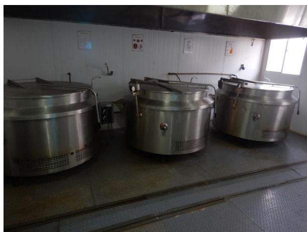
Figura 27: Vista geral das panelas industriais.
