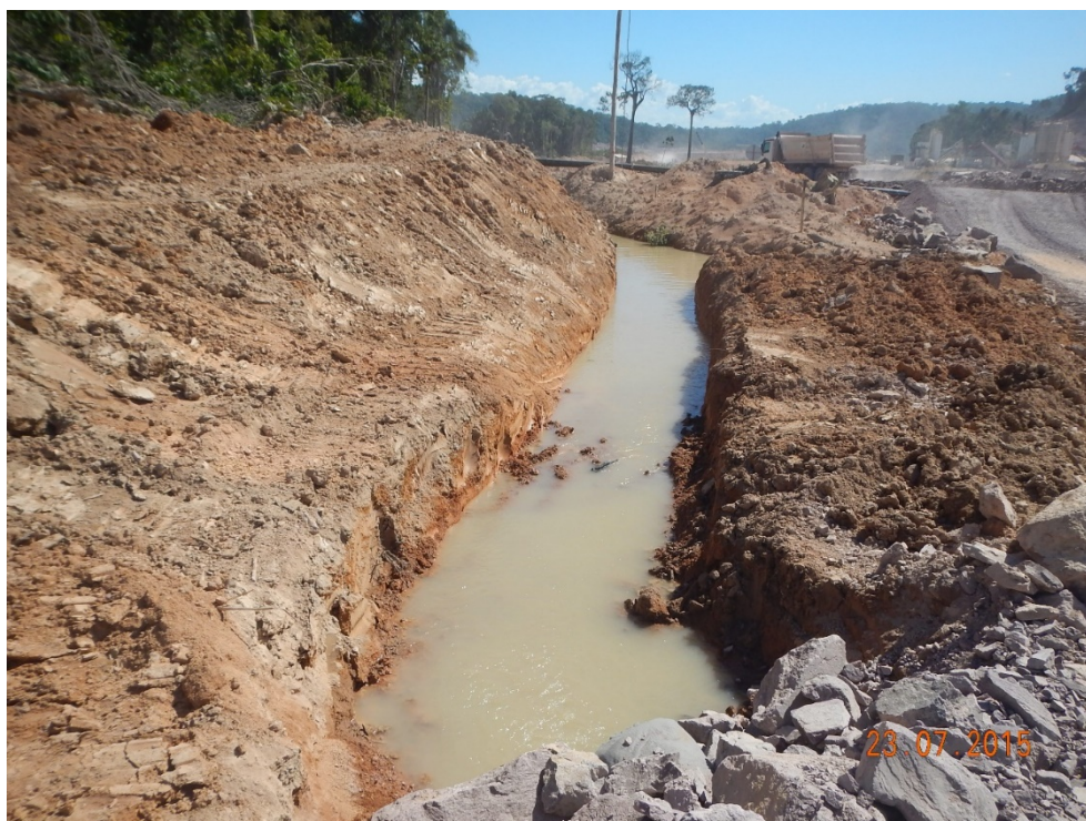
Figura 2: Vista geral do canal do vale e do canal de escoamento por gravidade até o rio Teles Pires.
