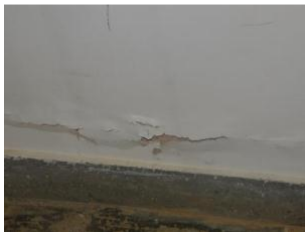
Figura 98: Parede com infiltração.
