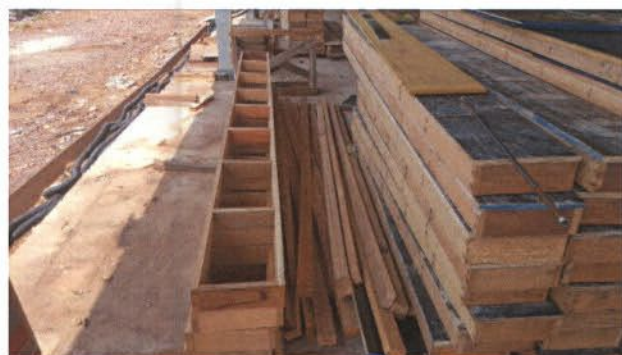
Figura 04 – Modelo similar de Caixaria, utilizada atualmente em outras obras civis do empreendimento.
