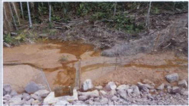
Fig. 112 – Drenagem de água próximo à passagem de fauna.
