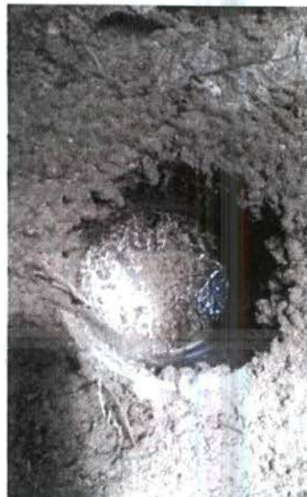
Foto 6: Pit-fall danificado por cupins
