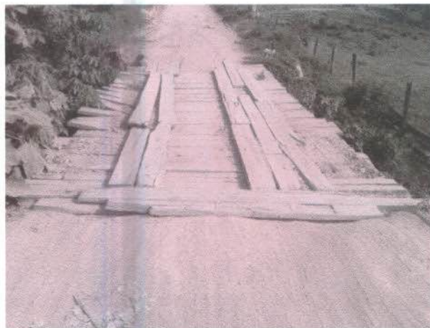
Ponte recém reformada destruída
