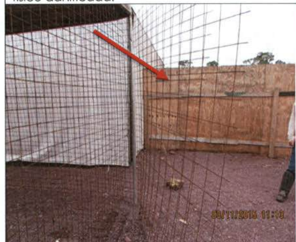
Figura 05: Todo o isolamento de grade, possuía o travamento por fios de aço, e os mesmos foram rompidos facilitando abertura.
