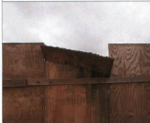
Figura 03: Parte da estrutura de isolamento físico danificada.
