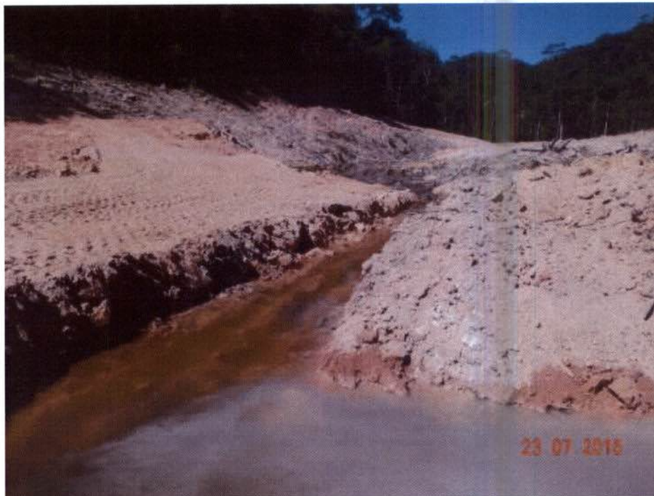
Figura 1: Vista geral do canal do vale e do canal de escoamento por gravidade até o rio Teles Pires.
