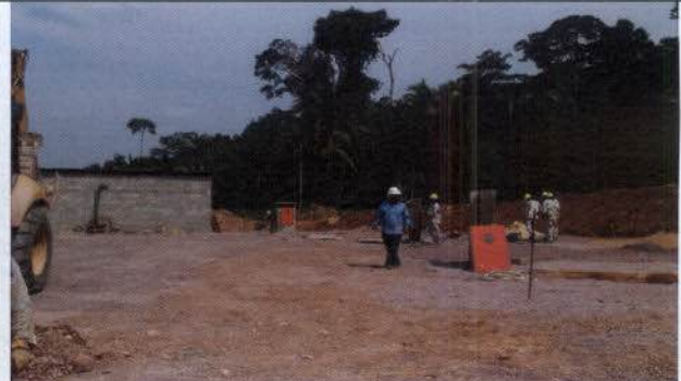
Foto 14 – Instalação do sistema de combate a incêndios no Plant de combustível definitivo.
