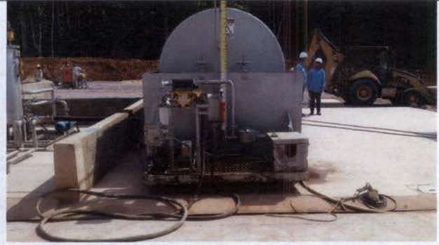
Foto 16 – Tanque de 15.000 litros com 1 bico injetor em operação no Plant de combustível definitivo.
