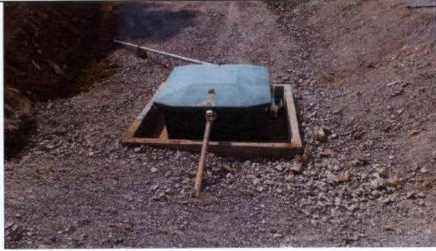
Foto 17 – Caixa SAO instalada no Plant de combustível definitivo.
