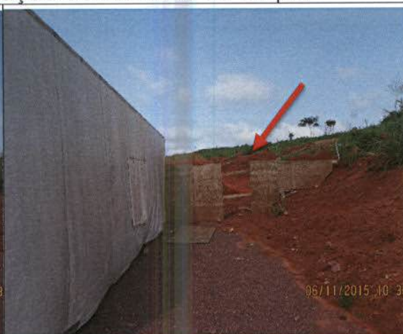
Figura 02: Vista para o isolamento da barreira física, de encontro ao talude, detalhe violação de estrutura.
