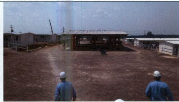
Foto 08 – Vista das salas de TV, que estão sendo construídas entre os alojamentos.
