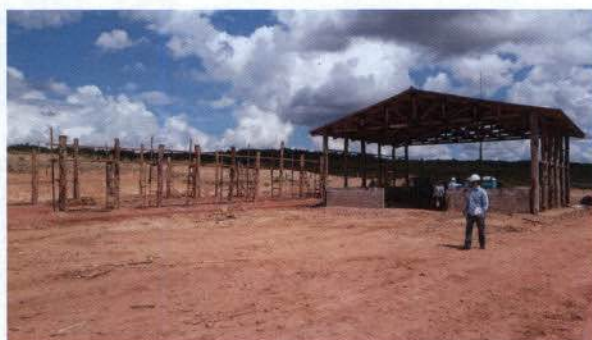
Fig. 05 - Local que será realizada a separação de resíduos no canteiro de obras
