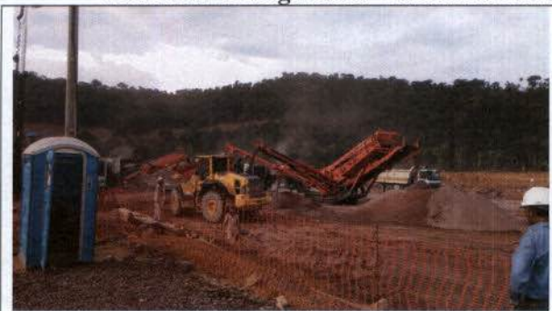
Fig. 49 – Central de Britagem móvel.
