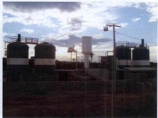
Fig. 08 - Estação de Tratamento de Efluentes (ETE) do canteiro de obras
