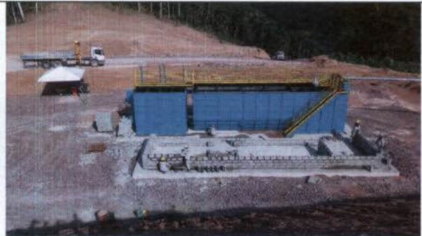
Fig. 42 – Estação de Tratamento de Água (ETA) do canteiro de obras.
