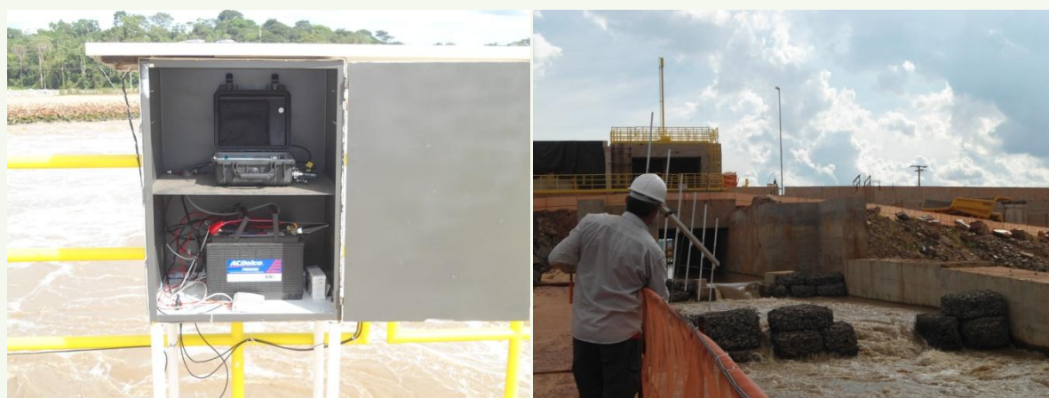
Figura 3. Base fixa e instalação de antena de radiotelemetria no STP da Ilha do Presídio.
