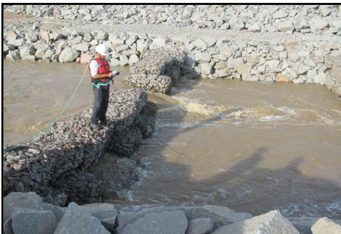
FIGURA 6. Medição de oxigênio dissolvido (mg/l) e temperatura (°C) no Sistema de Transposição de Peixes da ilha do Presídio em abril de 2012 – Usina Hidrelétrica Santo Antônio, rio Madeira - Rondônia.
