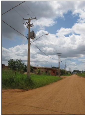
Foto 16: Vista da rua Capão da Canoa, em trecho dentro da Área 09 onde foi instalada rede de iluminação pública.
