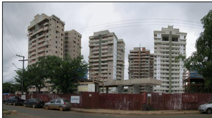
Foto 37: Vista de empreendimento localizado na Av. Lauro Sodré. Notar a evolução da obra em comparação com a visita de campo de maio de 2011.
