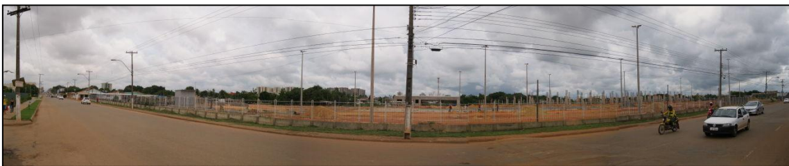
Foto 4: Vista do terreno onde está sendo construído o Instituto Federal de Educação. Notar na faixa central da foto, construção de pequena edificação completamente erguida.
