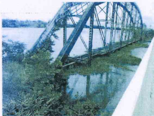
Figura 03 – Vista lateral da ponte. É visível, como na Figura 04, a perda de dormentes. O aumento do nível da água agravará este problema.
