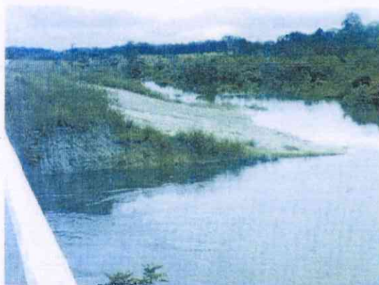
Figura 11 – As laterais dos canais necessitam serem estruturadas. Aparentemente foram apenas escavadas.
