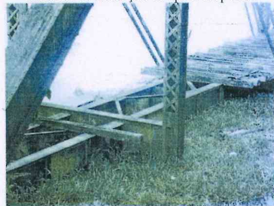
Figura 04 – Perda de barrotes que será agravada com o aumento do nível do rio.
