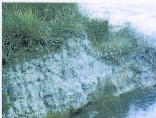
Figura 12 – Não há estrutura aparente de suporte para o solo, nem inclinação no talude que colabore para a estabilização do volume.
