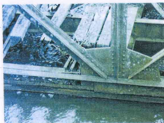
Figura 09 – Proximidade do nível do rio à base da ponte. Apesar de o nível ter baixado, a tendência natural pelas características climáticas é que o nível volte a aumentar.
