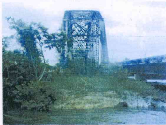
Figura 02 – Vista frontal da ponte. O nível da água, junto com a aparente falta de estrutura lateral do canal, apontam para uma necessária e imediata estruturação do apoio da ponte.
