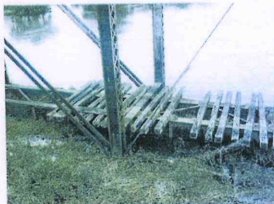
Figura 06 – Deterioração da estrutura da ponte e dos dormentes. A água agravará a oxidação, causando corrosão da estrutura metálica, e o apodrecimento das peças de madeira.
