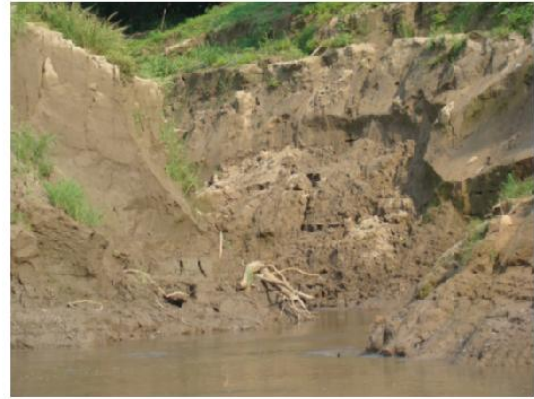
Perda de profundidade bem acentuada
