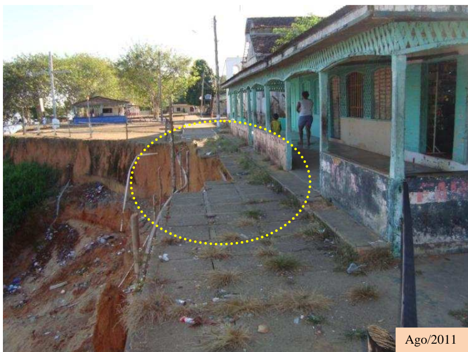
Figura 3.52. Detalhe do Processo Erosivo no LM-13 em Agosto de 2011
