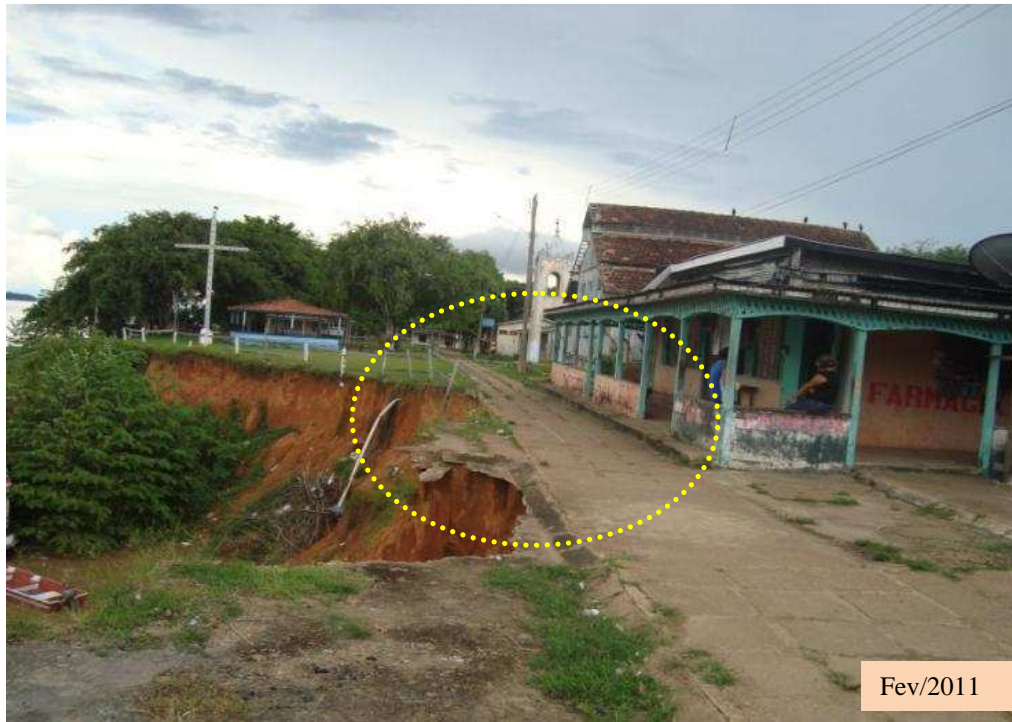
Figura 3.51. Detalhe do Processo Erosivo no LM-13 em Fevereiro de 2011
