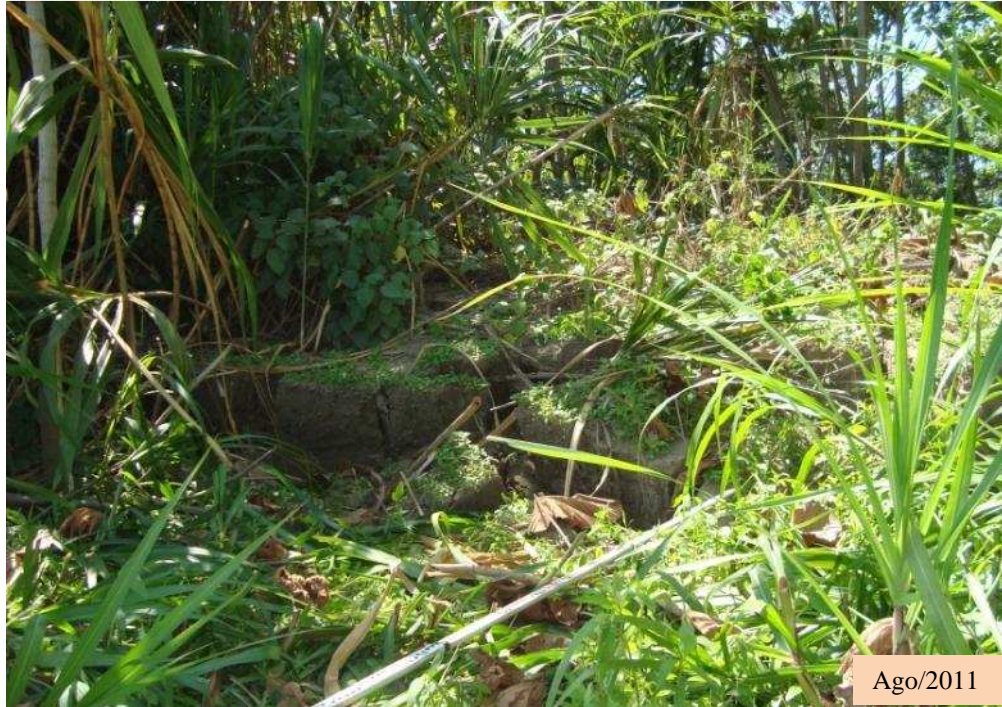
Figura 3.8. Vista Parcial do Afundamento da Margem no Local de Monitoramento 2
