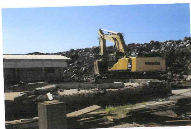
Demolição de pisos/ edificações de concreto, e aproveitamento do material gerado na regularização do terreno no local
