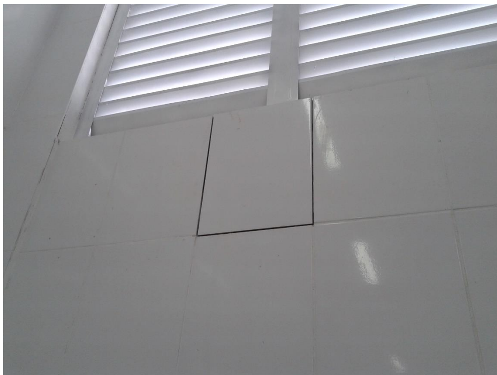
Foto 05 - Revestimento de parede sem rejunte - Processamento;
