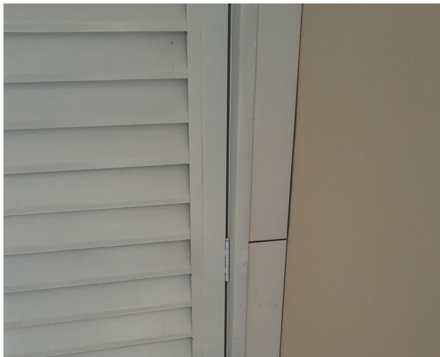
Foto 06 - Revestimento de parede sem rejunte - caldeira / depósito;
