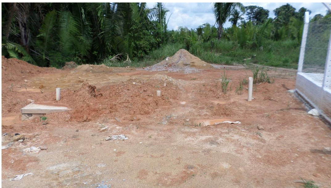
Foto 29 - Estação de tratamento de esgoto
