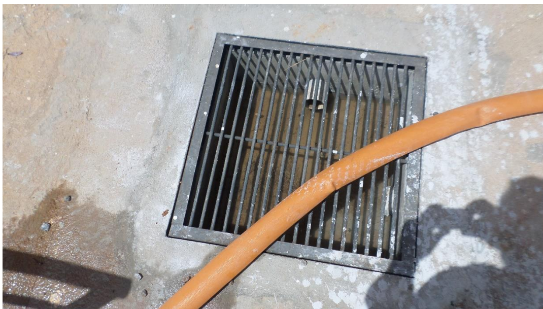
Foto 25 - Caixas de passagem
