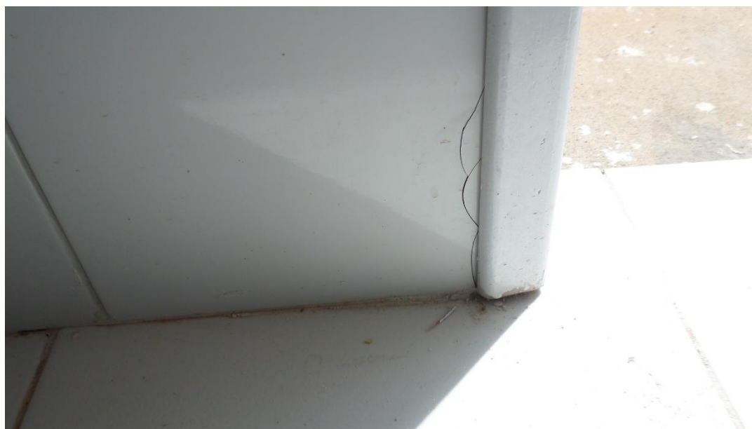
Foto 23 - Revestimento cerâmico quebrado
