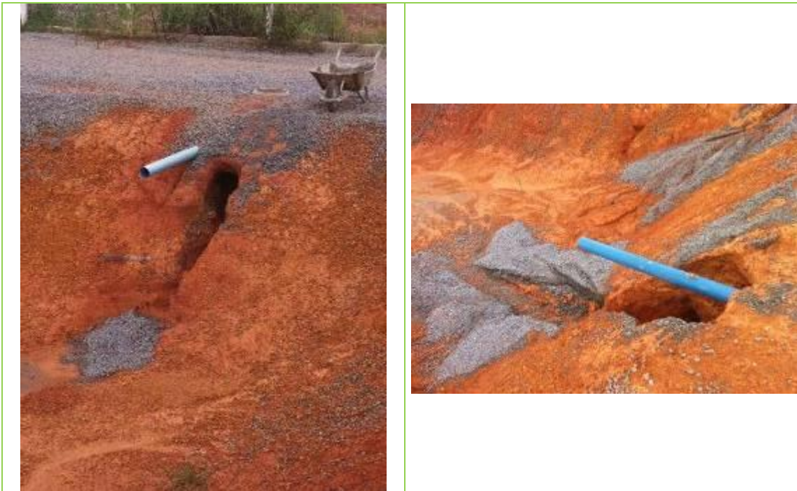
Erosões nos pontos de entrada de água dos viveiros de terra que deverão ser reparadas e compactadas
