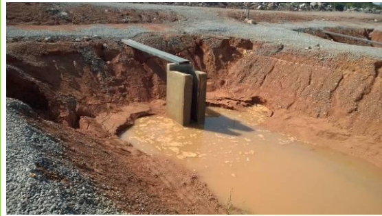
Solapamento dos fundo do tanque em função de acomodações e vazamentos nas conexões das tubulações de drenagem do monge
