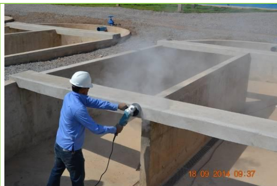
Detalhe de integrante da equipe da MEKA fazendo lixamento dos race-ways para o recebimento de resina
