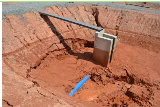
Detalhe de tanque que sofreu infiltração
