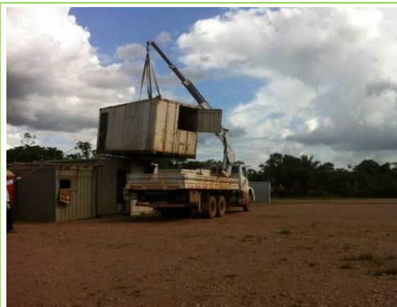
Containers instalados na piscicultura parceira para servir de apoio logístico e almoxarifado
