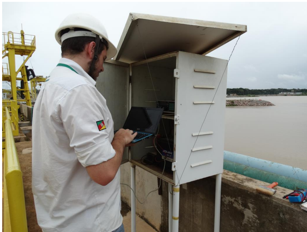
Figura 7: Base fixa de radiotelemetria instalada na UHE Santo Antônio.
