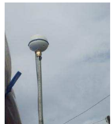
Antena para DGPS
