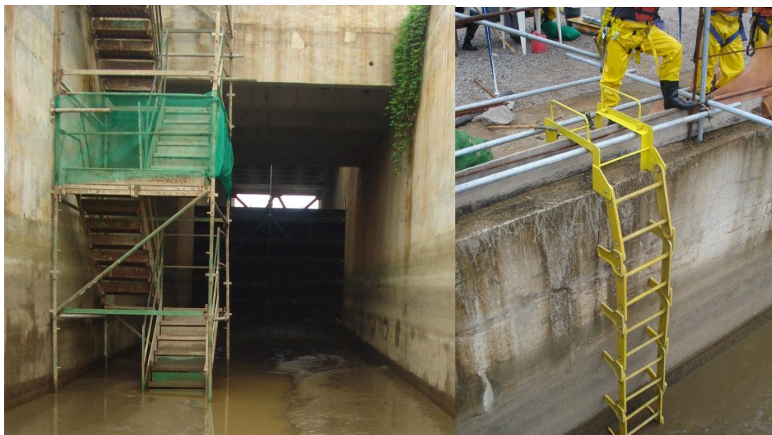
Figura 3 - Escadas instaladas para acesso ao canal do STP durante resgate de peixes em março de 2014: escada metálica de cimbramento, mostrando a comporta de montante fechada ao fundo (esquerda) e escada-marinheiro afixada em estrutura de tubo roll (direita).
