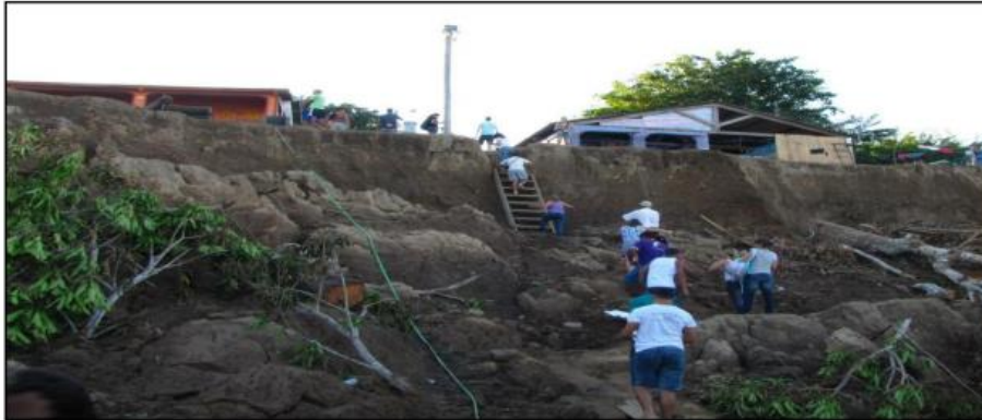
Figura 5 - Vista parcial do local de embarque e desembarque, com sinais evidentes de um escorregamento recente. Na parte superior pode ser observada uma escada improvisada para facilitar o acesso e, uma casa comercial sendo desmanchada Fonte: Arquivo do autor / Junho de 2011
