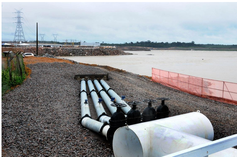
FIGURA 10. 1: Sistema de adução de água da CAERD, inaugurado em novembro/2012. O sistema permite a adução da água da estrutura de captação, localizada na barragem da UHE Santo Antônio, até a Estação de Tratamento de Água (ETA), operada pela CAERD.
