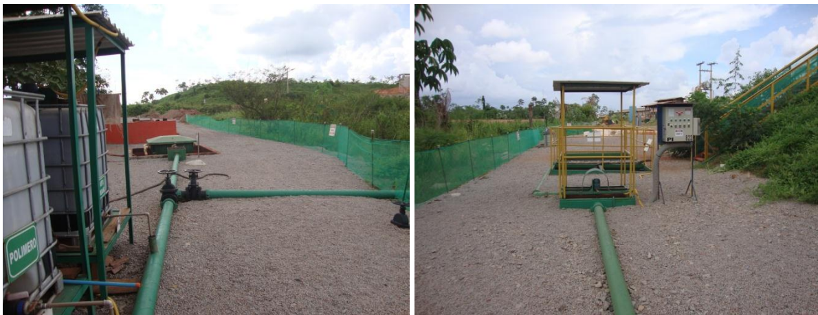
FIGURA 2. 12 - Sistema de reuso do efluente oleoso da caixa separadora de água e óleo – SAO - rampa de lavagem e lubrificação de veículos pesados – ME.
