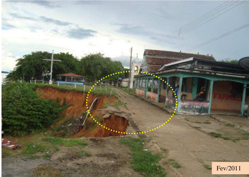
Figura 3.59. Detalhe do Processo Erosivo no LM-13 em Fevereiro de 2011
