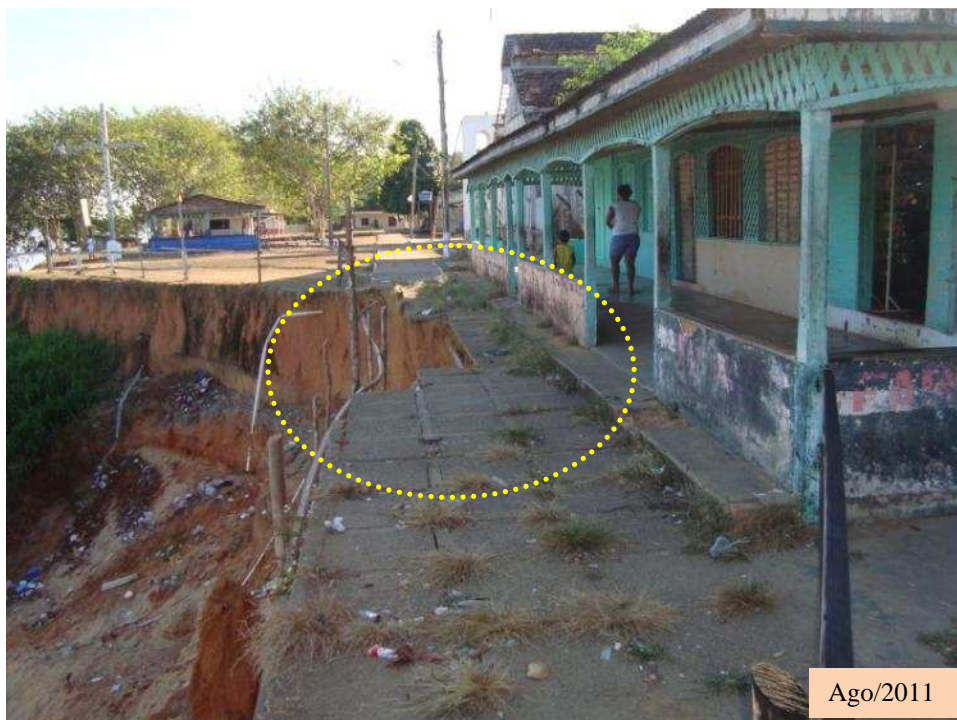
Figura 3.60. Detalhe do Processo Erosivo no LM-13 em Agosto de 2011
