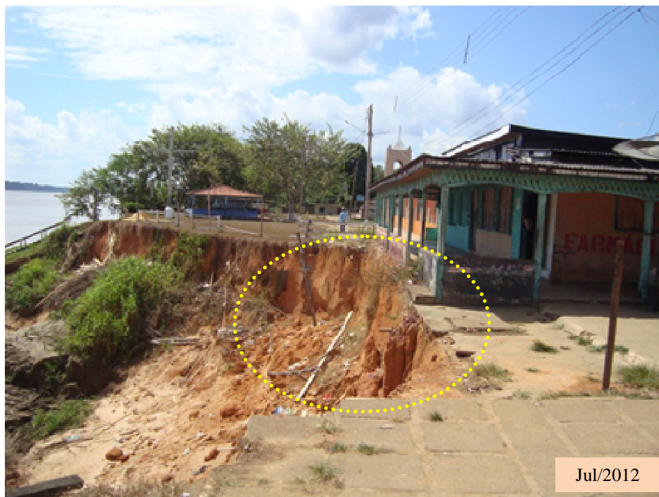
Figura 3.61. Detalhe do Processo Erosivo no LM-13 em Julho/2012
