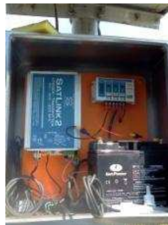
Gabinete aberto para limpeza
