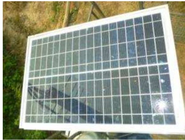
Placa solar limpa
