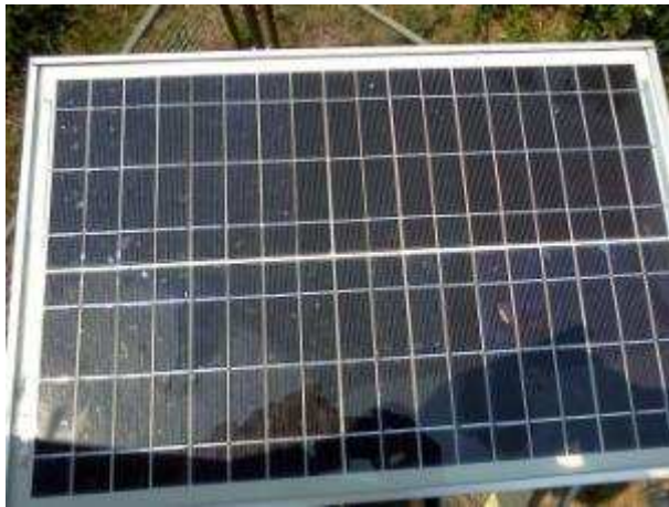
Placa solar limpa
