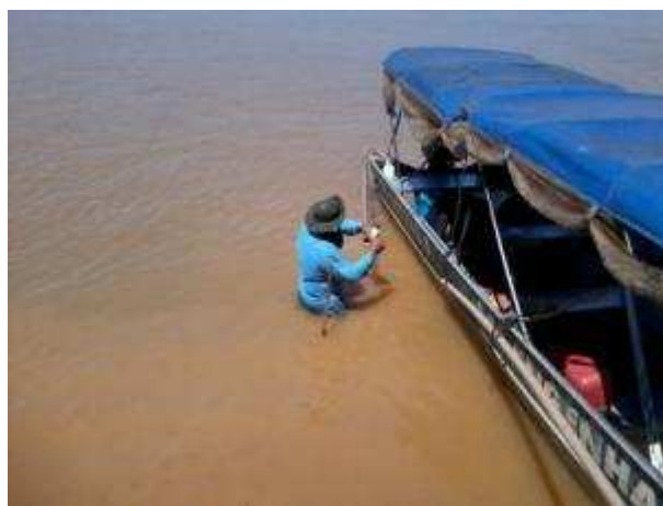
Pesquisa de local para cravar cantoneira para fixação de prolongamento da tubulação de 50 mm.
