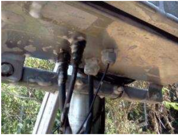
Limpeza dos bornes e conexões
