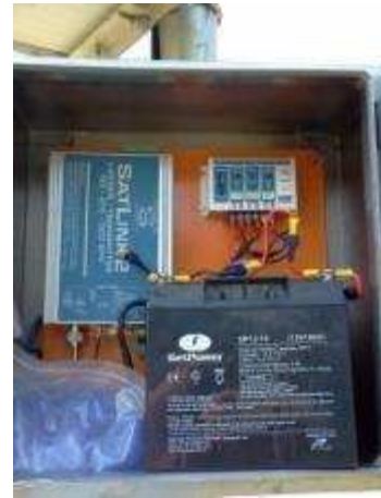
Gabinete aberto para limpeza
