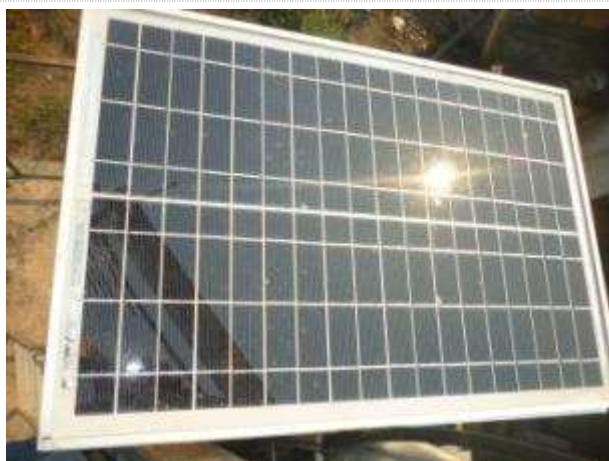
Placa solar suja
