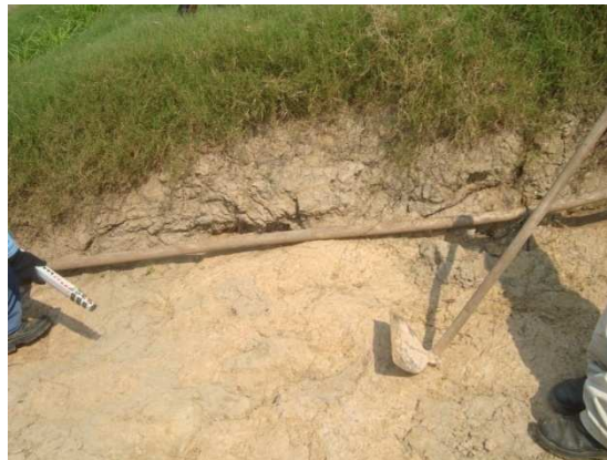
Situação encontrada. Tubulação exposta.
