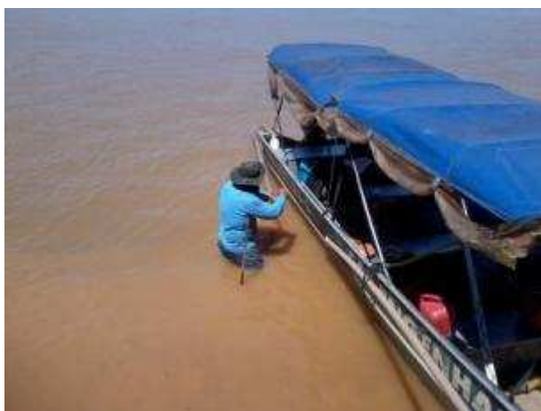
Pesquisa de local para cravar cantoneira para fixação de prolongamento da tubulação de 50 mm.
