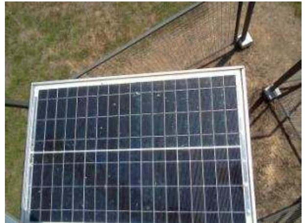
Placa solar limpa
