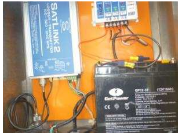
Gabinete aberto para limpeza
