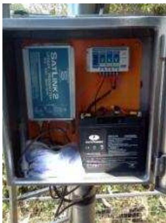
Gabinete aberto para limpeza
