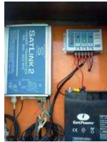
Gabinete aberto para limpeza
