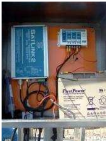
Gabinete aberto para limpeza
