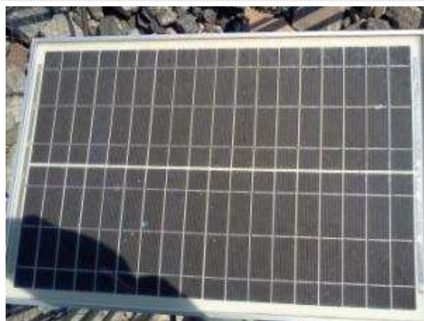
Placa solar suja
