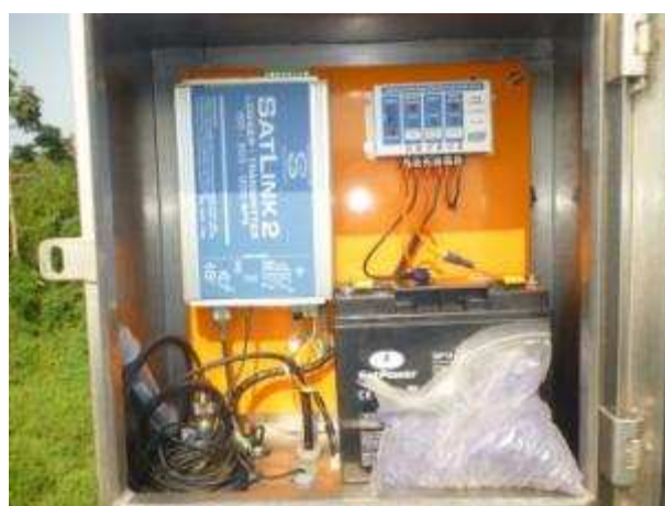
Gabinete aberto para limpeza e retirada dos dados
