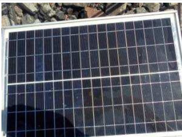
Placa solar limpa
