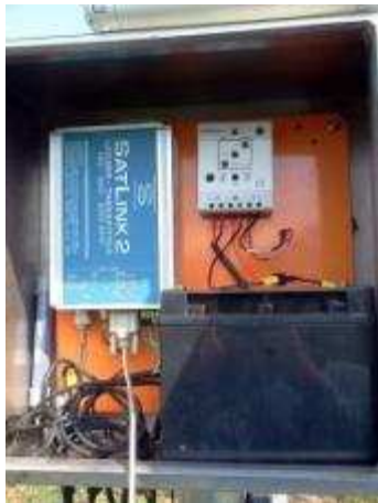
Gabinete aberto para limpeza e retirada dos dados
