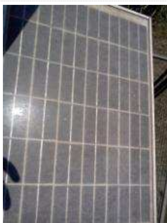
Placa solar suja
