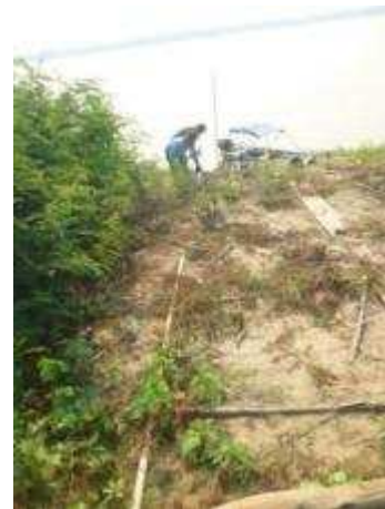
Tubo da instalação exposto
