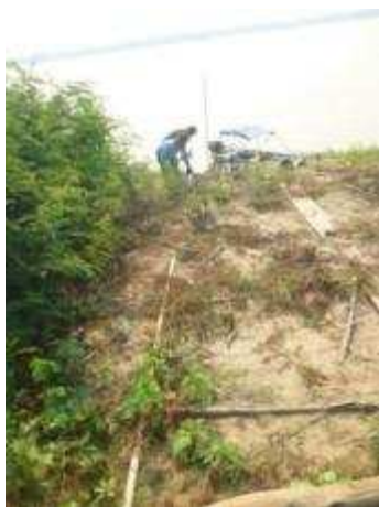
Tubo da instalação exposto
