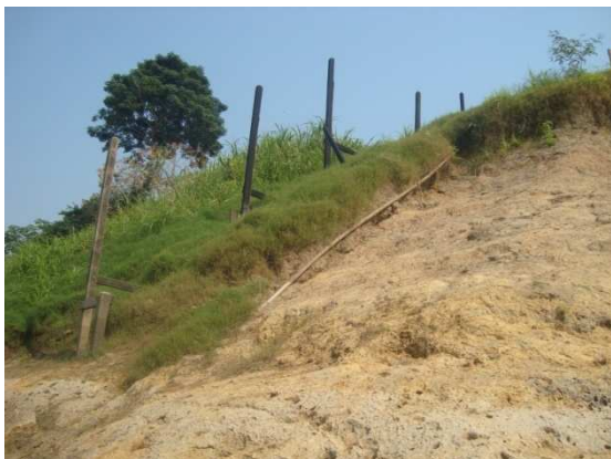
Situação encontrada. Tubulação exposta.
