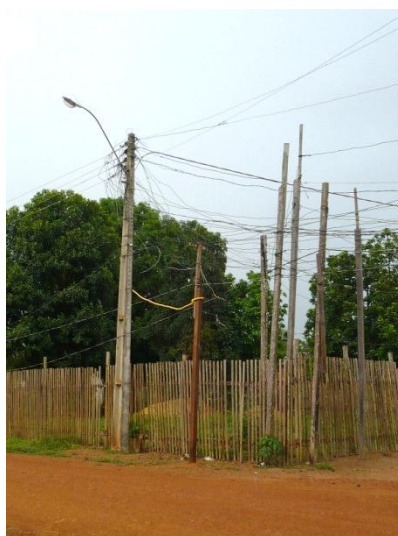
Foto 19 - Posteamento regular ao lado dos da rede elétrica clandestina presente na Área.
