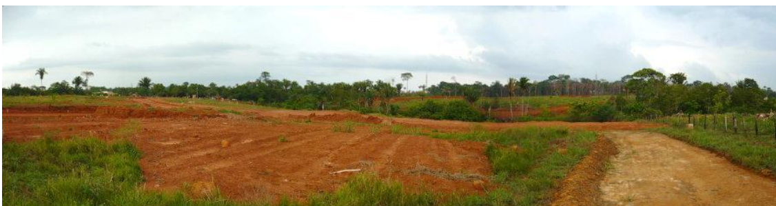
Foto 8 - Vista da porção norte do loteamento Novo Horizonte. Ao fundo, à esquerda, tratores realizando trabalhos de terraplanagem, e à direita, novo terreno do loteamento em processo de terraplanagem.
