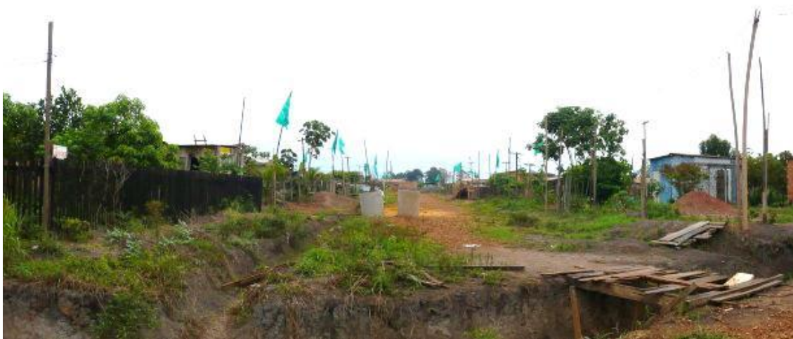
Foto 18 - Vista de rua no interior da ocupação. Notar valas e manilhas de concreto dispostas na via de circulação e posteamento improvisado para a passagem de energia elétrica clandestina.
