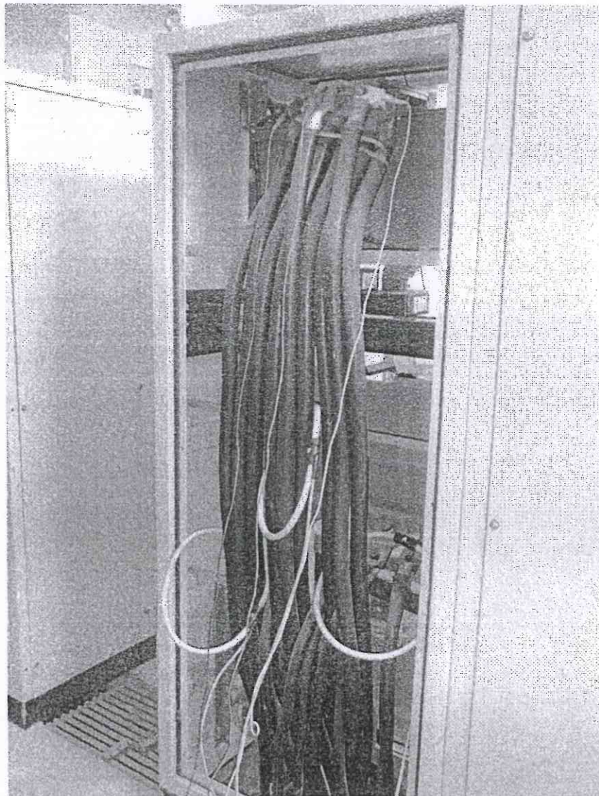
Imagem 2 - Sensores de corrente e de tensão instalados no Quadro Geral de Baixa Tensão.
