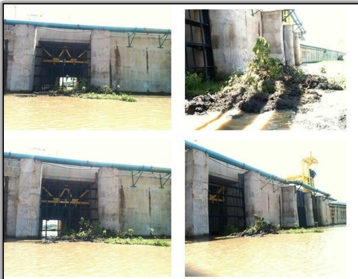
Figura 15. Saída a montante do STP obstruída pela vegetação UHE Santo Antônio, rio Madeira, Porto Velho/RO, em janeiro de 2013.
