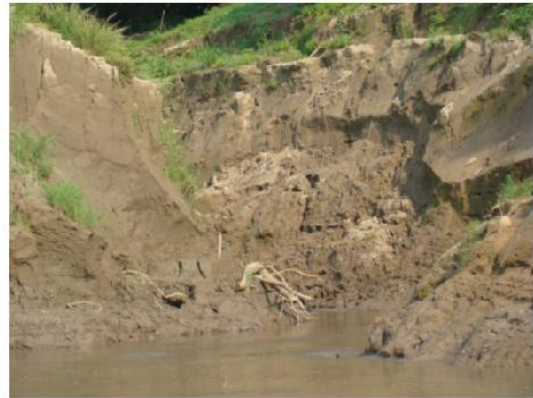
Perda de profundidade bem acentuada
