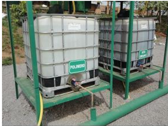
FIGURA 2. 12: Efluente recebendo polímero e veta da bomba dosadora de produto para coagulação dos sólidos sedimentáveis.
