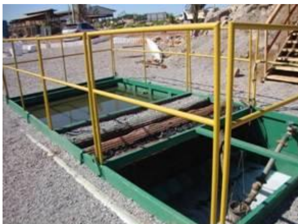
FIGURA 2. 14: Tanque decantador, filtro e reservatório da água tratada para ser reutilizada na lavagem dos equipamentos da Rampa de Lavagem e Lubrificação.
