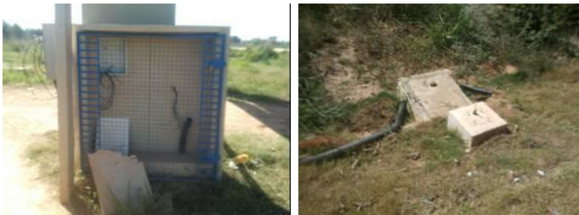
FIGURA 27. 4: Evidências das ações de vandalismo no “Parque Municipal do Jacy-Paraná”.
