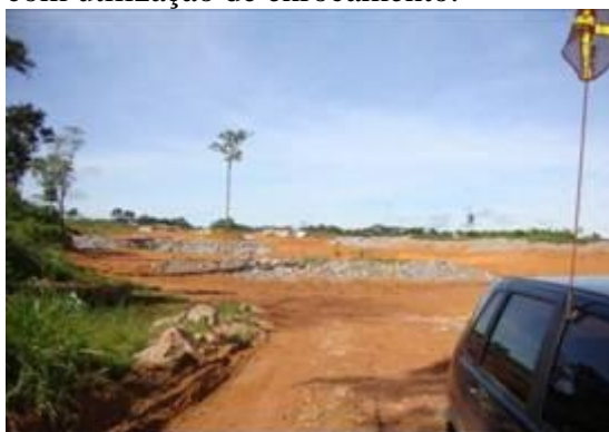
FIGURA 2. 19: Açã de melhoria no AMD 07 - JT 07 – implantaã de cordã de rocha no entorno das bacias de decantaã.
