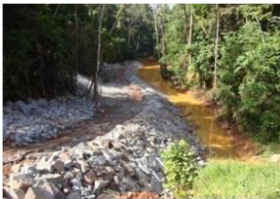
FIGURA 2. 17: Açã de melhoria no AMD 07 – retirada do material carreado para o igarapé e implantaã de dique de contenã (cordã de rocha) no lado esquerdo - sentido portaria → JT 07.
