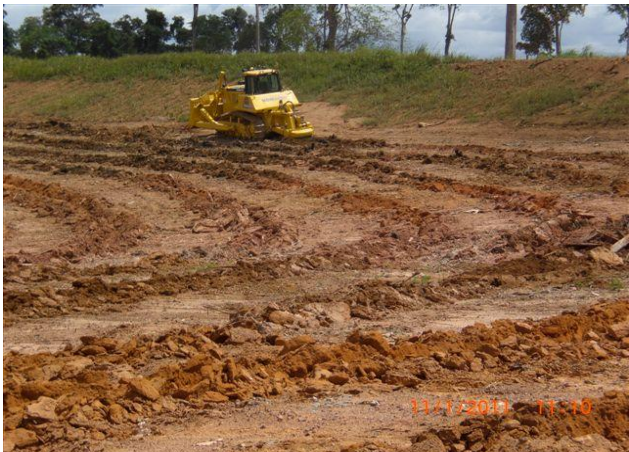
Figura nº 10. 11/01/2011 - Abertura de sulcos em nível na superfície do terreno da jazida JT 07 - MD. Sulco aberto numa profundidade de 0,60 m com trator de esteira equipado com ripper
