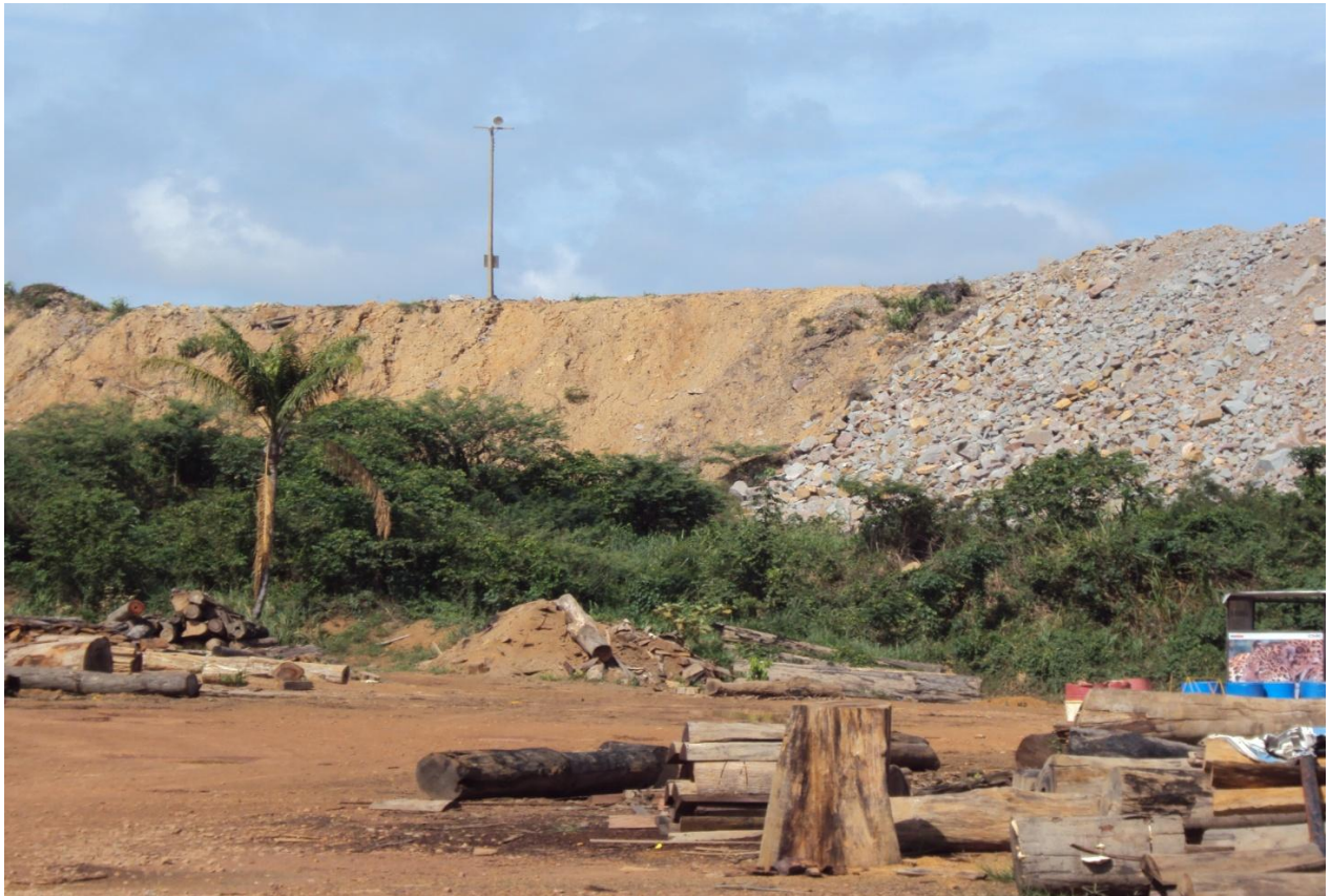
Figura nº 26. 07/10/2010 - Lançamento de solo em parte da superfície do talude do bota fora de rocha, na face voltada para o canteiro pioneiro, com objetivo de favorecer o uso futuro do material estocado e a harmonização paisagística
