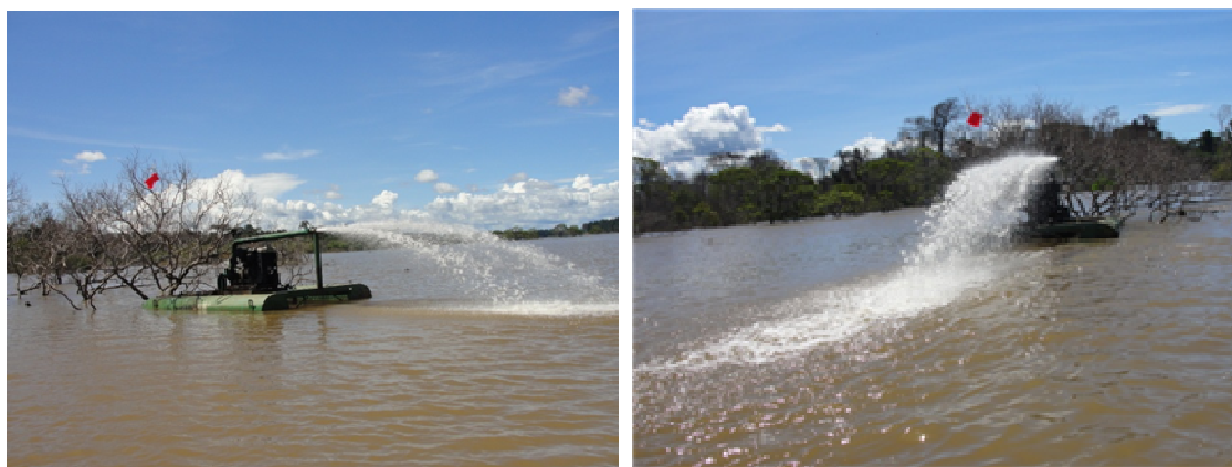
FOTO 10. 13: Bomba 1 operando no igarapé Jatuarana. Foto tirada em 02/03/2012
