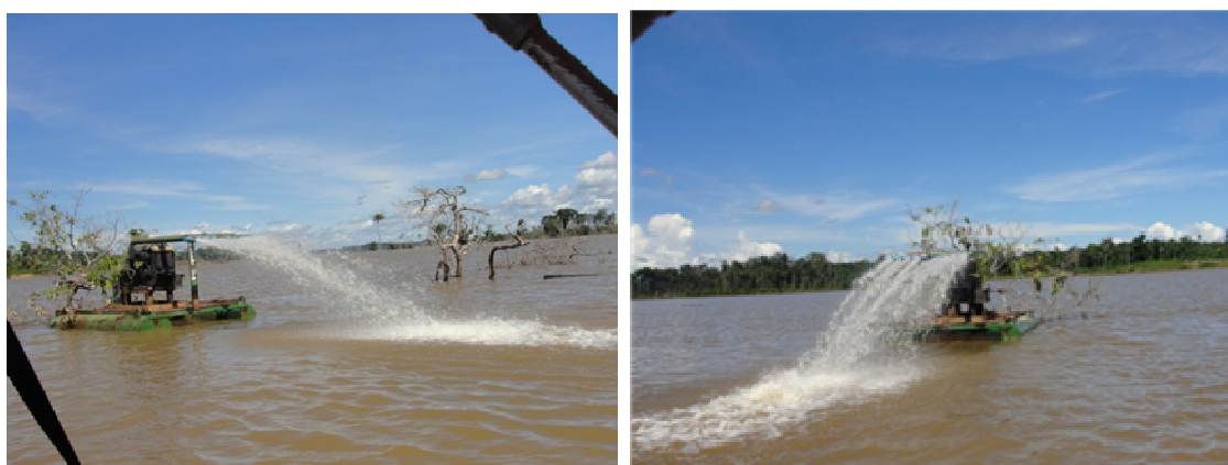
FOTO 10. 14: Bomba 2 operando no igarapé Jatuarana. Foto tirada em 02/03/2012.
